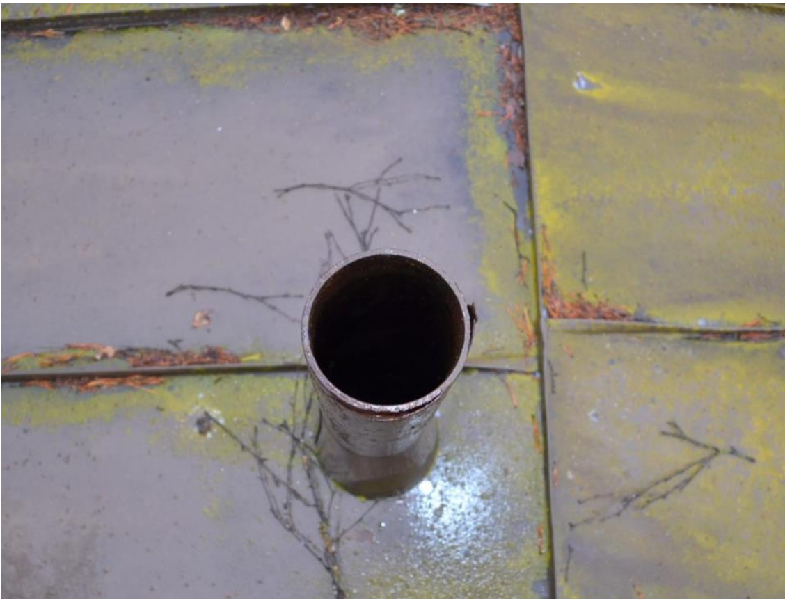
Kuva 17. Viemäriin tuuletusputki (Luukkonen&Leikas 2019-11-12)
