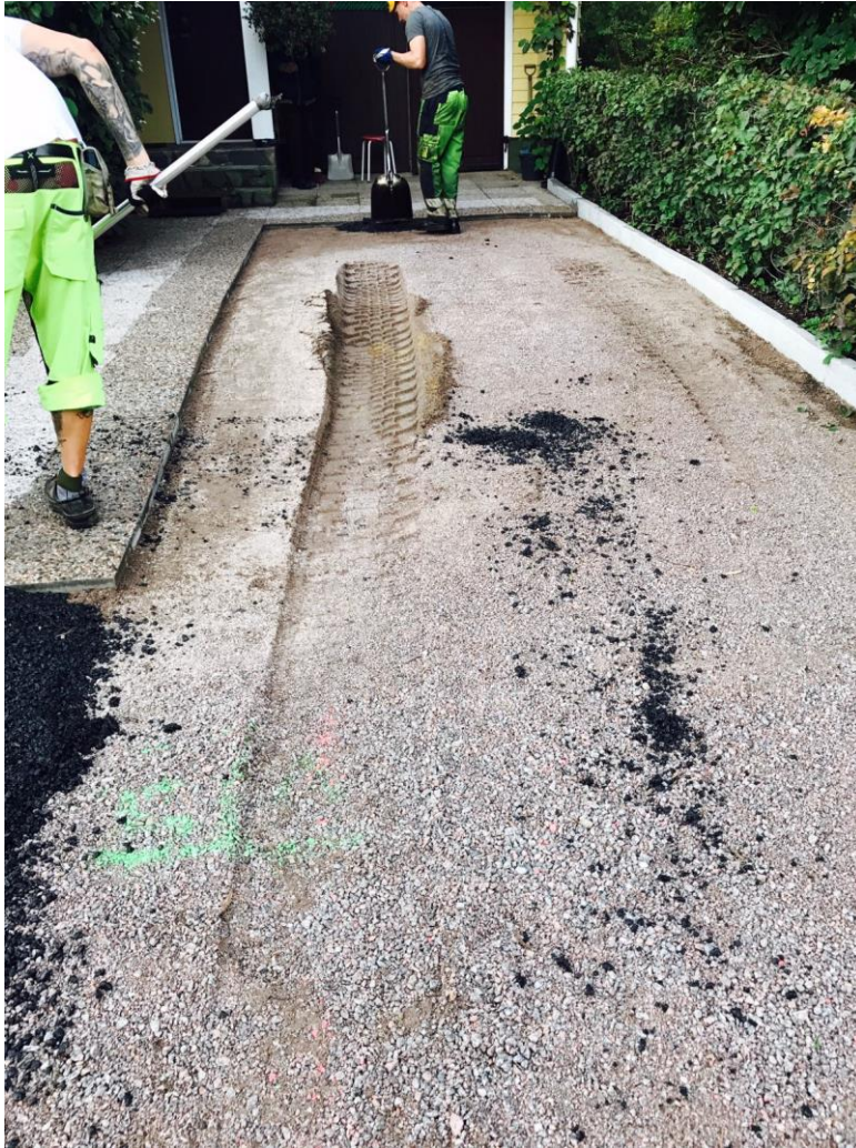
Kuva 1. Asfaltinlevittimen renkaat ovat uponneet asfalttipohjiin murskeen lajittumisen seurauksena.
