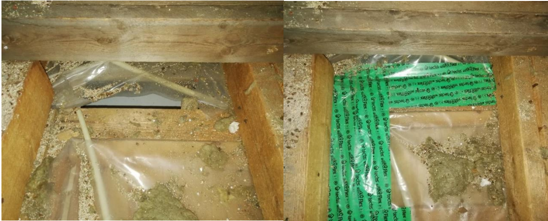
KUVA 25. Halkeama höyrynsulussa keittiön kohdalla
