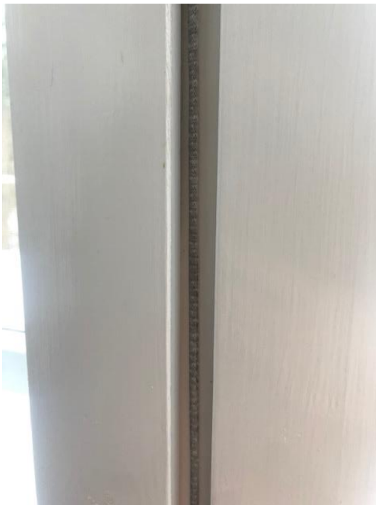
KUVA 2. Irronnut ikkunan tiiviste
