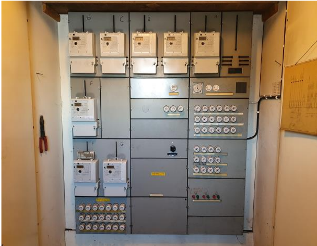
Kuva 24. Kiinteistön pääkeskus (Kirjoittajan kuva).
