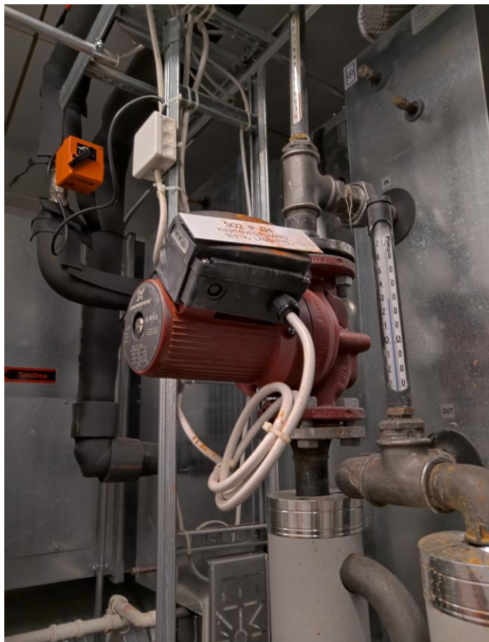
Kuva 3. Kuvassa induktiomotorilla varustettu nestevoideltu pumppu. Pumpun päällä integroitu elektroniikka, mm. relemoduuli.
