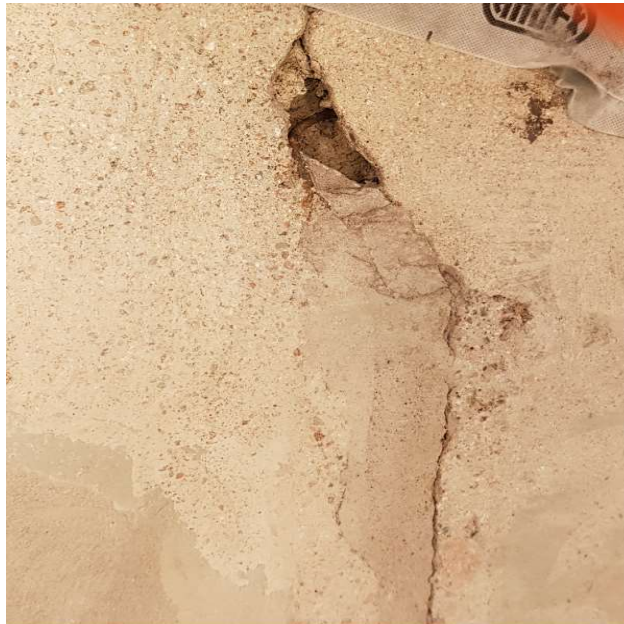
Kuva 7. Alapohjalaatassa oli lähes koko puukäsityöluokan pituinen, rakennuksen suuntainen halkeama.
