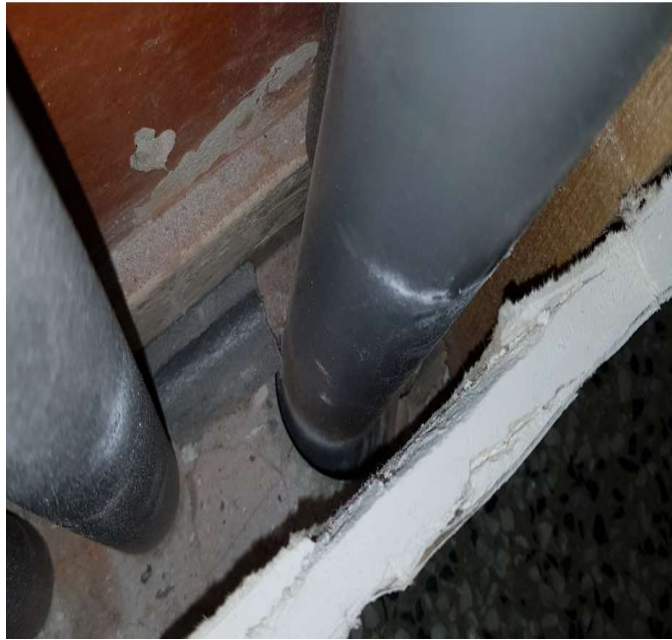
Kuva 42. Vesijohtojen putkiläpiviennit välipohjaan eivät ole tiiviitä.
