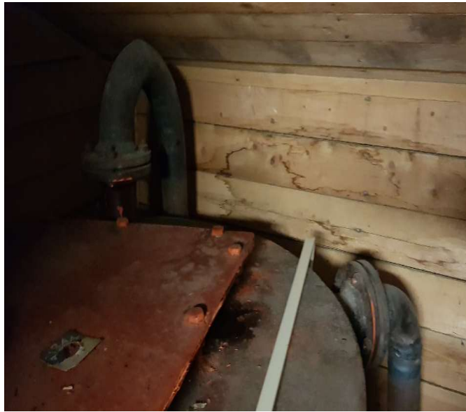
Kuva 47. Vanha käytöstä poistetun avopaisunta-astian ympäristössä jälkiä vuotovedestä.
