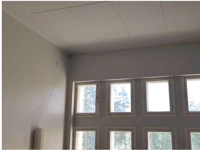
Kuva 36. B-portaan ylimmän kerroksen ulkoseinän ja porrashuoneen seinässä oli havaittavissa selvä halkeama, jonka aiheuttaja tulisi selvittää.
