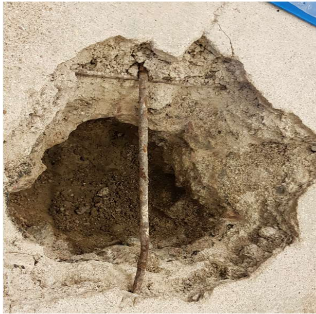
Kuva 8. Alapohjalaatassa alustäyttö oli hyvin hienojakoista ja märkää.
