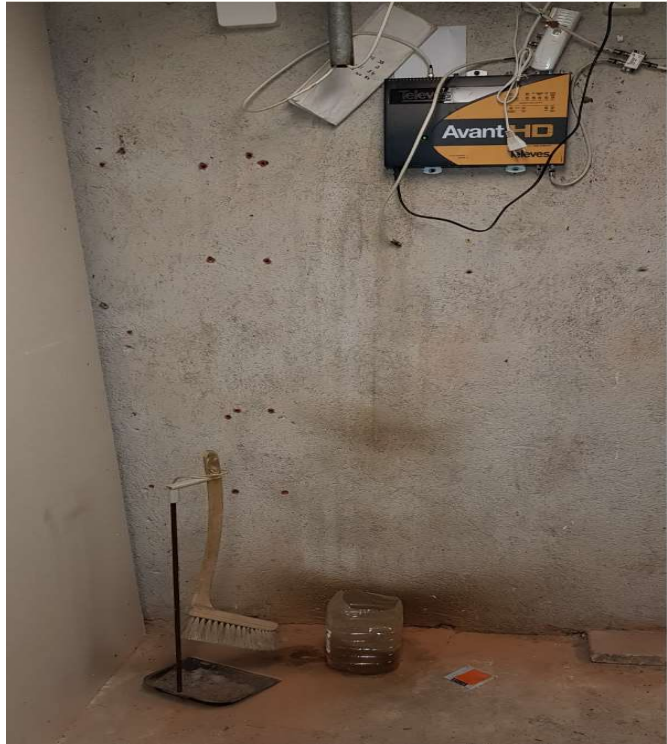
Kuva 50. Vesiastia vuotavan antenniläpiviennin alla.
