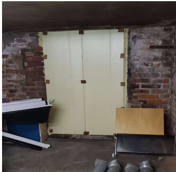
Kuva 18. Kellarin vanhan hiilikuilun oviaukko on peitetty eristelevyllä. Seinärakenne aukon ympärillä on märkä
