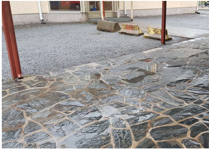
Kuva 13. Sadevedet kastelevat katoksen alapuolisen laatan, joka toimii osittain kellarin holvina
