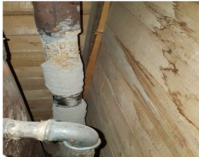
Kuva 48. Vanha käytöstä poistetun avopaisunta-astian putkissa jäämiä mahdollisesta asbestieristeestä.
