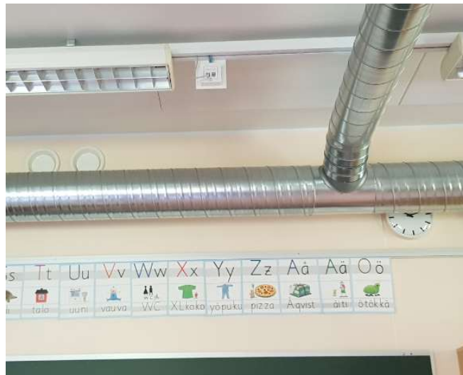
Kuva 52. Luokissa oli havaittavissa vanhoja poistoilmanvaihtoventtiileitä, joita ei oltu tukittu / tiivistetty. On mahdollista, että tietyssä olosuhteessa vanha poistoilmahormi toimii korvausilmareittinä.
