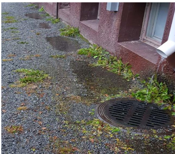
Kuva 24. Ränni- ja sadevedet lammikoituvat rakennuksen seinustalle
