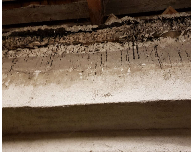
Kuva 49. Bitumisively sisältää asbestia
