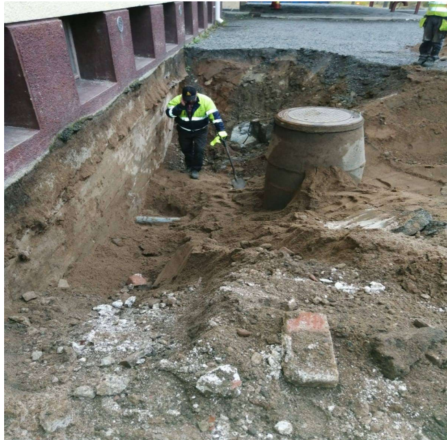
Kuva 16. Itäpuolen maanvastaisissa seinissä ei ole vesi- ja lämmöneristystä.
