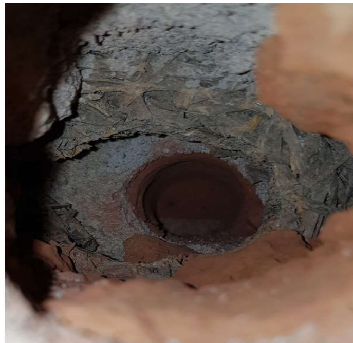
Kuva 37. Ulkoseinän patterisyvennyksen vaurioitunut sementtilastuvillaeriste.
