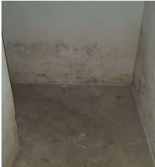
Kuva 21. Lämmönjakuhuoneen portaiden alla seinissä havaittavissa kosteusjälkiä.
