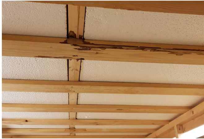
Kuva 11. Välinevaraston holvin EPS-eristyksen tukipuussa mikrobikasvustoa
