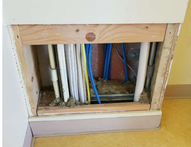
Kuva 40. Tekniikkakuilu luokassa 205. Välipohjan läpiviientä ei ole tiivistetty.
