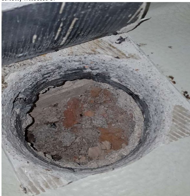
Kuva 45. Opettajain huoneen wc:n Välipohjan rakenneavaus. Bitumikermi PAH-pitoisuus ylittää ongelmajätteen rajan.
