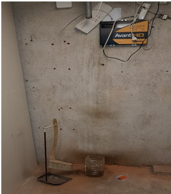
Kuva 29. Vesiastia vuotavan antenniläpiviennin alla.
