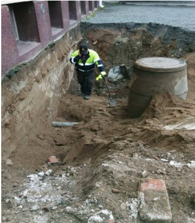
Kuva 23. Sokkelin eristeissä, läpivienneissä ja salaojissa oli puutteita
