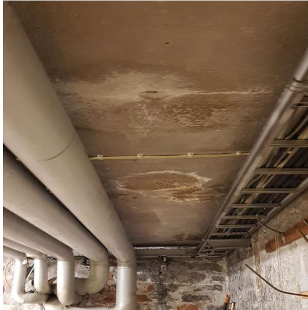
Kuva 20. Polttoainevaraston holvissa oli nähtävissä kosteuden aiheuttamia jälkiä.
