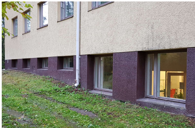
Kuva 12. Kellarin ikkunoiden korkeustasoa maanpintaan nähden on paikoin olematon
