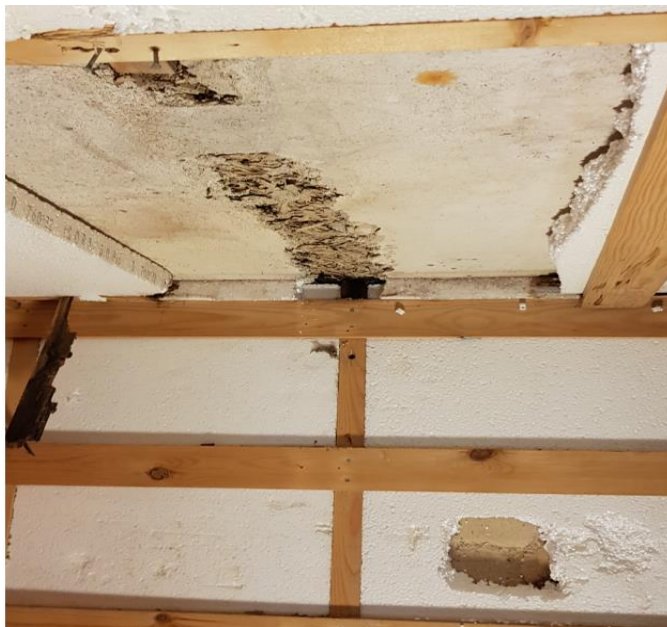
Kuva 11. Kellarin holvin alapinnassa sementtilastuvilla lämmöneristeenä, alkuperäisestä piirroksesta poiketen.
