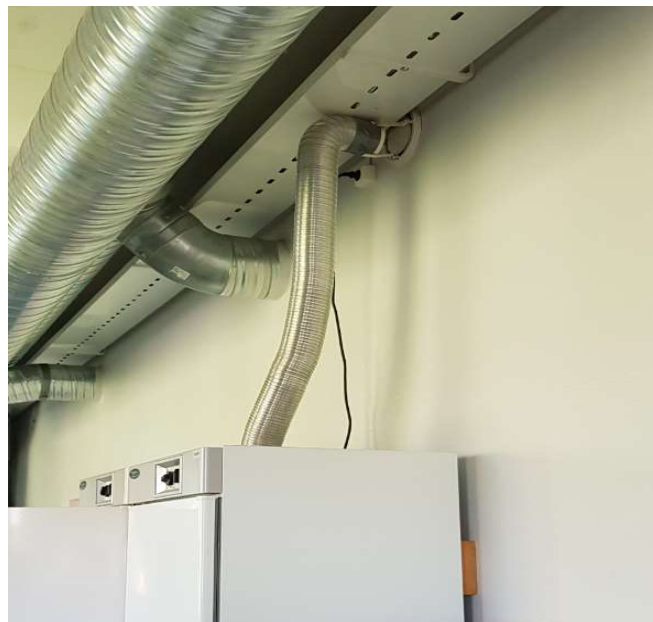
Kuva 53. 3. kerroksen käytävällä kuivauskaappi on kytketty vanhaan poistoilmahormiin. Vanha hormi tulisi tukkia, ilmanvaihdon suunnitelman mukaisen toiminnan varmistamiseksi.
