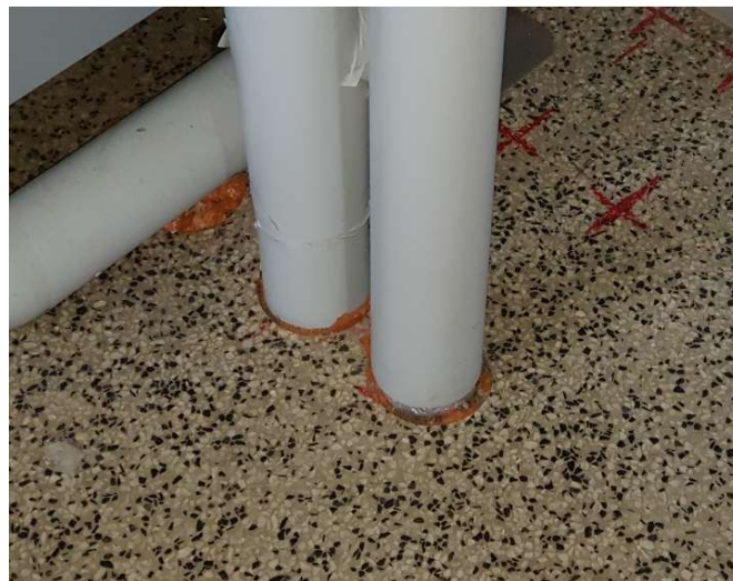
Kuva 41. Uusittujen ilmanvaihtokoneiden putkiläpiviennit välipohjaan eivät ole tiiviitä.
