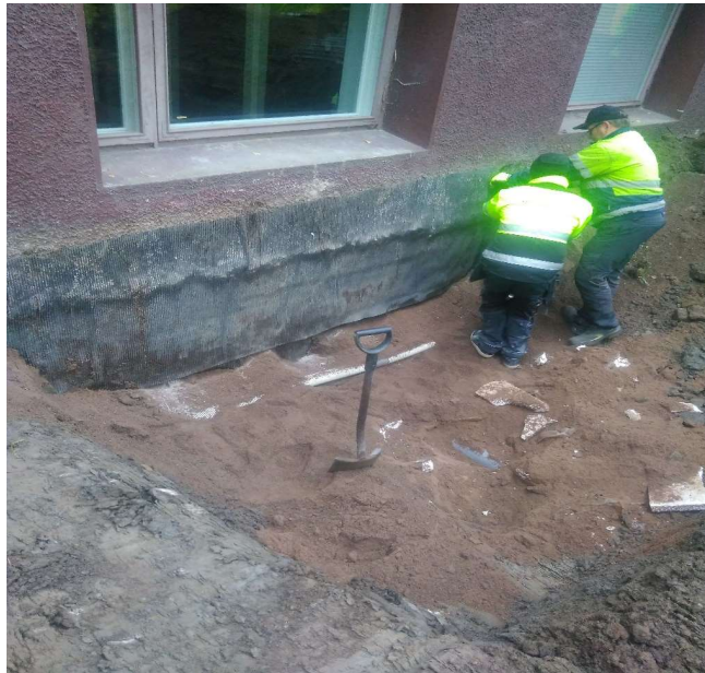
Kuva 17. Länsipuolen maanvastaisissa seinissä oli paikoin patolevy, mutta ei vesieristystä.
