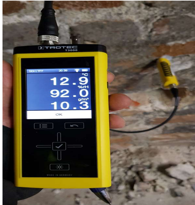
Kuva 28. PR11, Kellarin polttoainevaraston maanvastainen seinä, RH 92 %.
