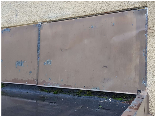
Kuva 35. Katoksen pellityksessä on puutteita
