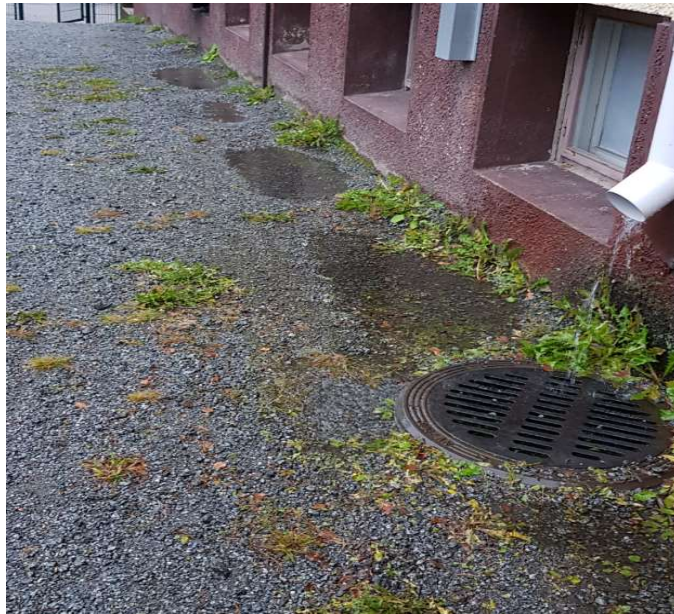
Kuva 15. Sadeveden ohjauksessa ja pintarakenteiden kallistuksissa on puutteita
