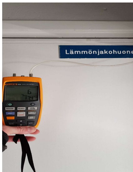
Kuva 56. Kellarin tekniset tilat olivat tarkastushetkellä 6Pa ylipaineisia porrashuoneeseen nähden.
