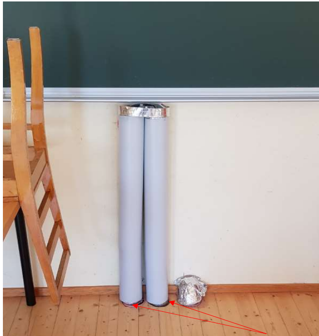
Kuva 55. Ilmanvaihtokoneiden tekniikkäläpivienti luokassa 203. Läpiviennit eivät ole tiiviitä
