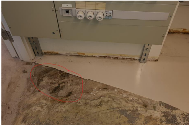
Kuva 22. Mikrobikasvustoa lattiapinnoitteen alla AP1.
