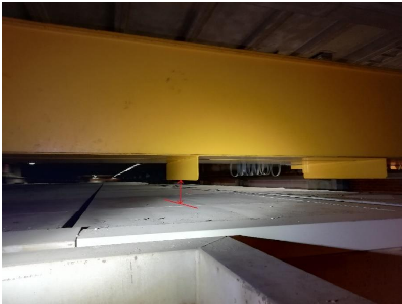
Kuva 34. Siltanosturin ripojen ja koneen eristeiden välinen tila on noin 30 senttimetriä
