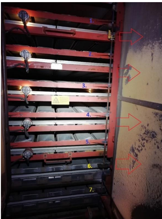
Kuva 17. Puhallinkaapin näkymä ovelta päin katsottuna
