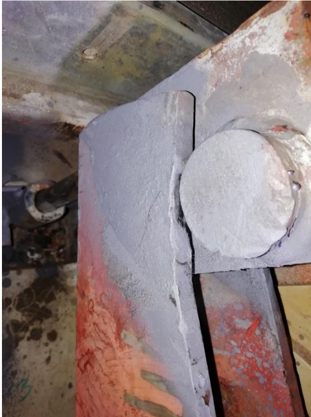
Kuva 27. Nostokäpälien ja vastintapin liukupinnat eivät ole kohteeseen sopivia
