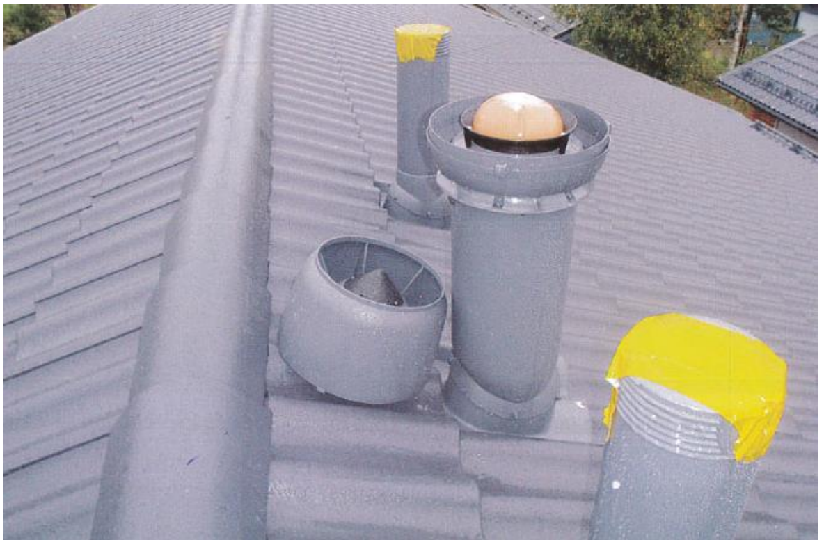
Kuva 4. Pientalon vesikatolla kumipallolla tulpattu tuuletusputki [7, s. 45.]
