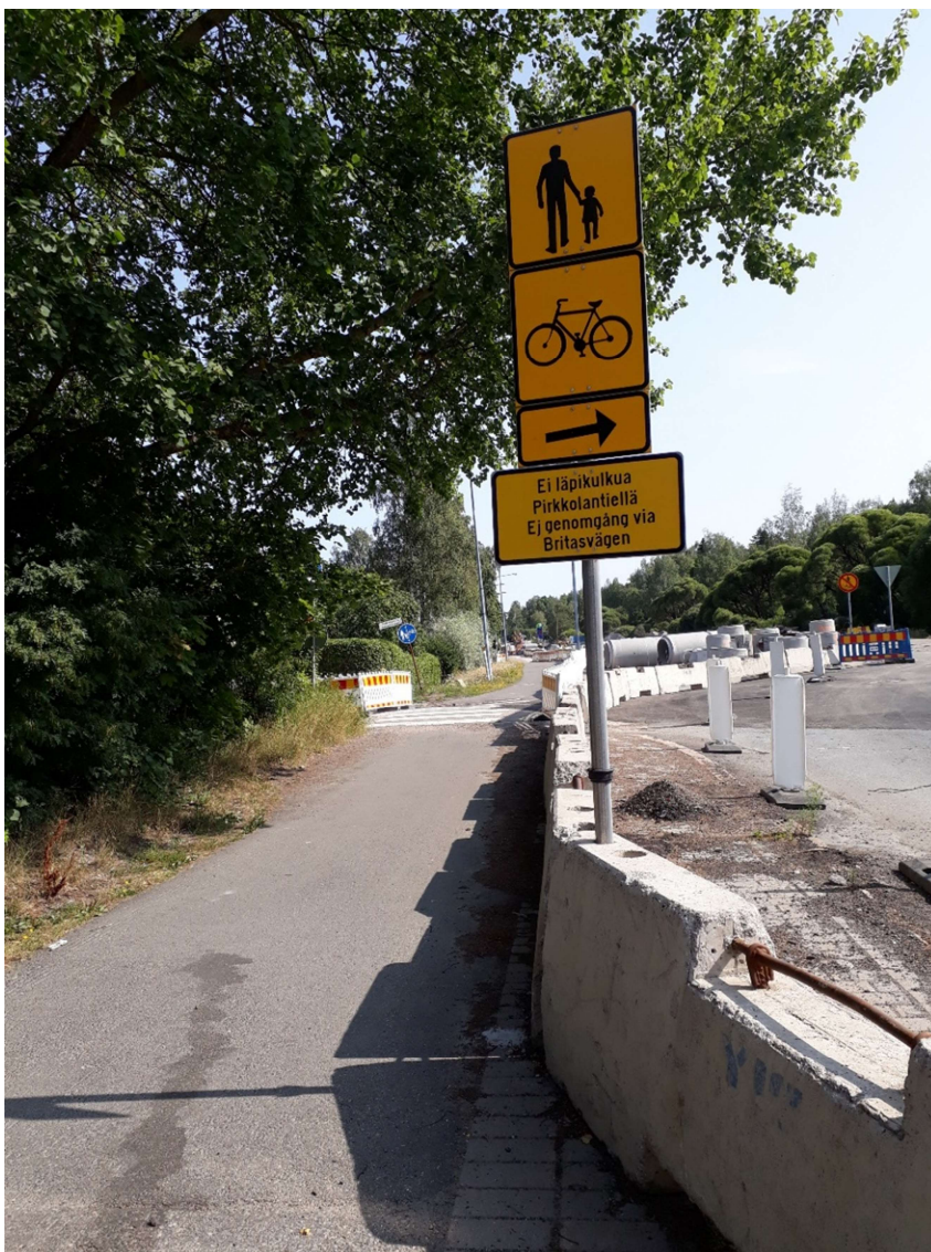
Kuva 11. Opastus on hoidettu ilmoittamalla, että tästä ei saa kulkea
