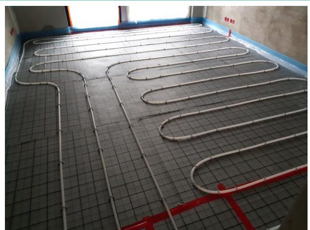
6. Valmiissa huoneistossa putket on asennettu kuvien mukaisesti ja kytketty taivutustukineen sekä vuodonilmaisimineen jakotukkiin.
