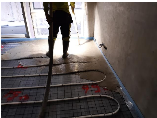
5. Valu aloitetaan valettavan alueen kauimasta nurkasta. Massaa lasketaan letkusta tasaisesti ja rauhallisesti pyörittäen siten, että korkolaput peittyvät juuri ja juuri.
