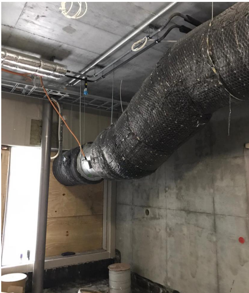
Kuva 22. Redin Loiston työmaa-aikainen savunpoistokanava on kohteen suuruuden vuoksi todella iso, jonka takia sen asentaminen vei huomattavasti ylimääräistä aikaa. 89
