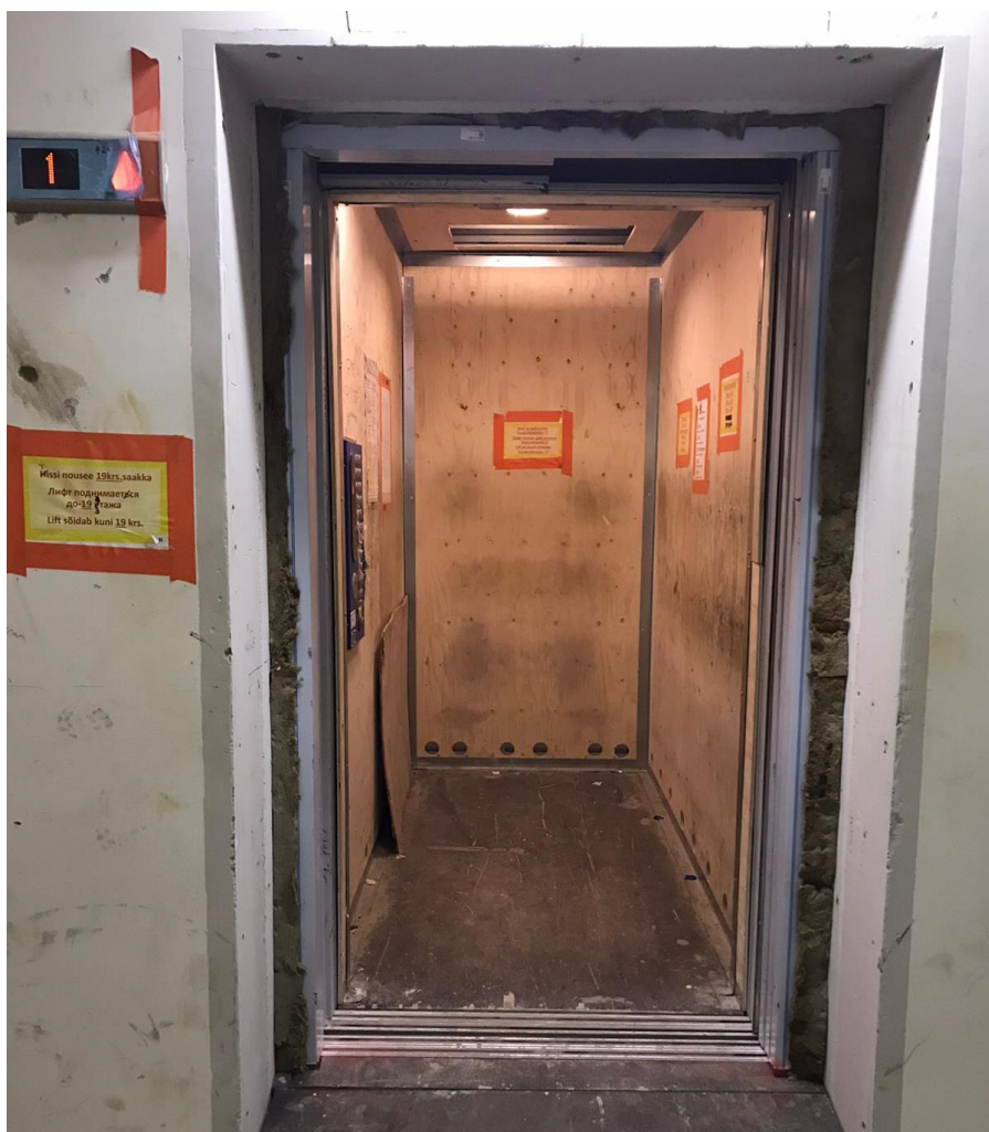
Kuva 19. Jumplift-hissi palvelee työntekijöitä pitkään työmaalla, kunnes kori vaihdetaan pysyvään malliin, ja hissi siirtyy asukkaille käytettäväksi heti luovutuksen jälkeen. 79
