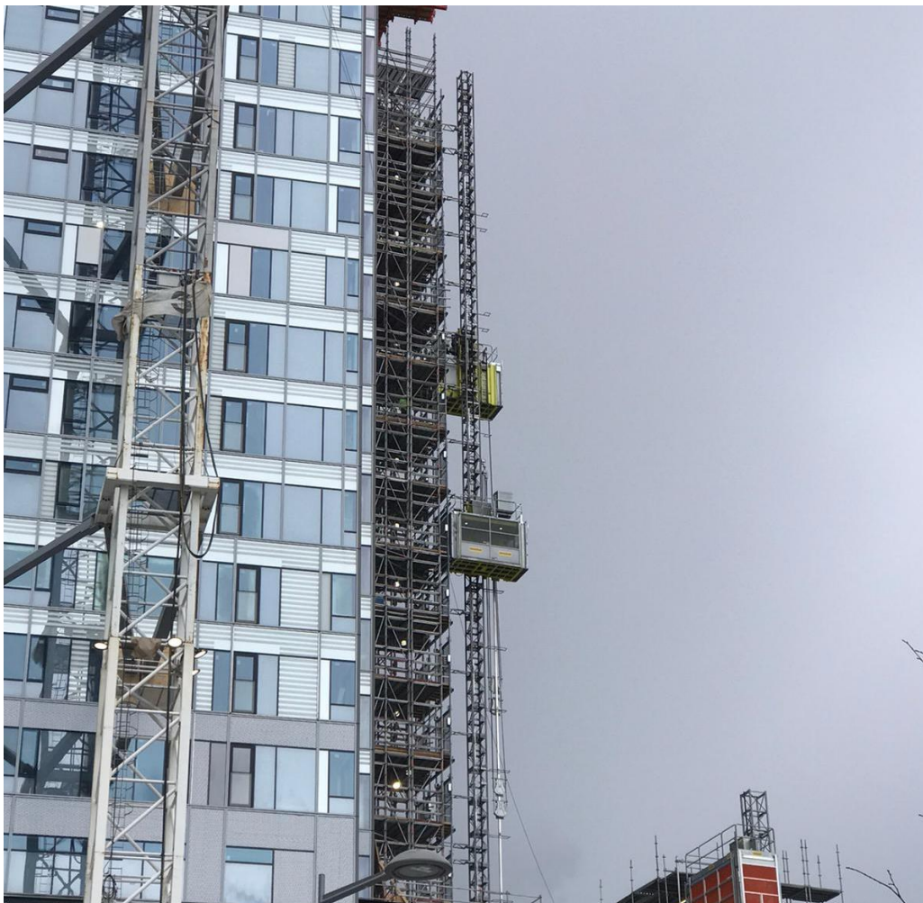
Kuva 20. Redin Majakassa ja Loistossa toimiva Scanclimberin Twin-työmaahissi on traditionaalisempi työmaahissi, jossa on kaksi koria. Loistossa toinen on varattu logistiikalle, ja toinen työntekijöille. 81
