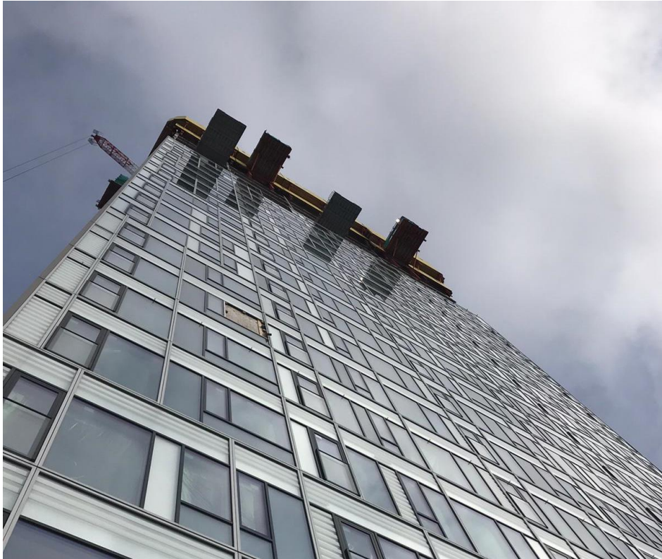
Kuva 13. Julkisivuelementtien asentaminen sääsuojaseinän haalaustasojen alapuolelle on haastavaa, mutta oikeilla välineillä ja menetelmillä täysin mahdollista. 67
