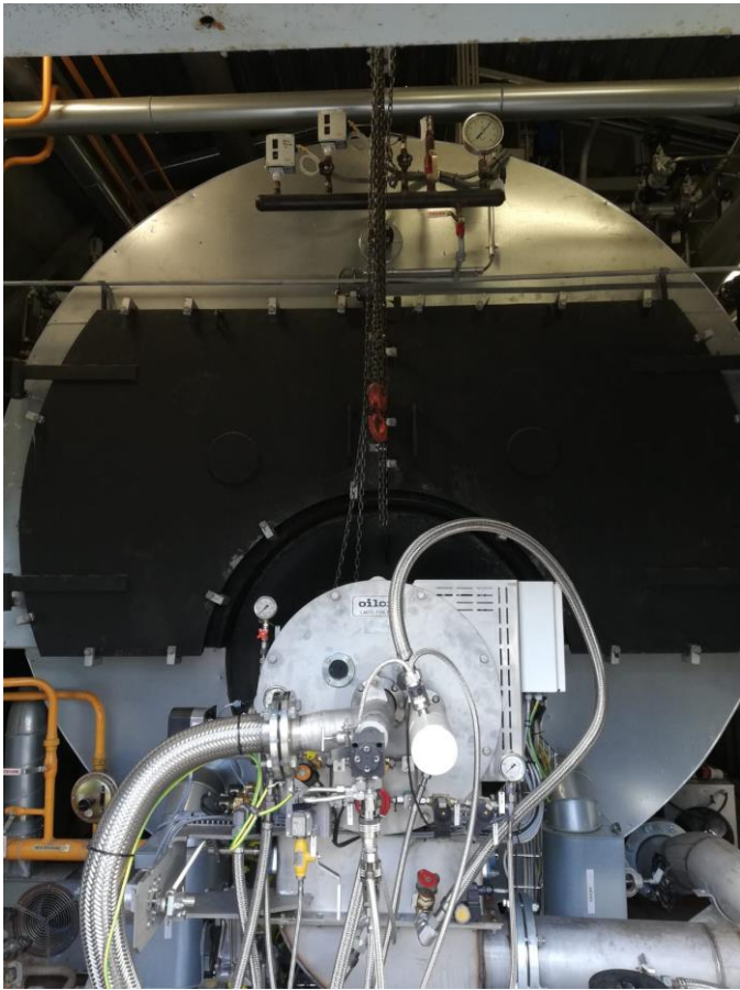
KUVA 2. Kolmevetoinen suurvesitilahöyrykattila kevyt polttoöljy ja nestekaasu käyttöisellä hajukaasupolttimella
