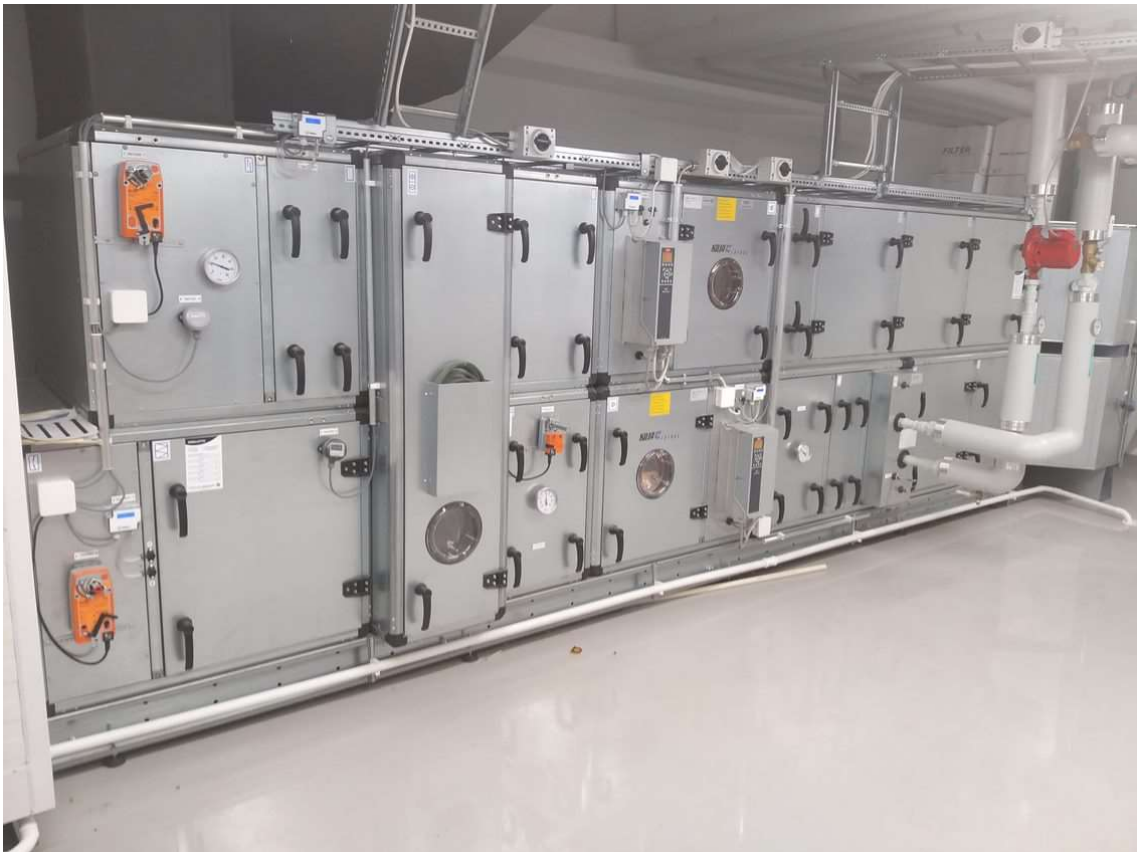
KUVA 8. Ilmastointikone, S-Market nro 2
