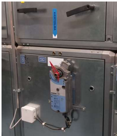
KUVA 4. Sekoitusosa ja sitä säättävä moottori ilmastointikoneen ulkopuolelta katsottuna, S-Market nro 1
