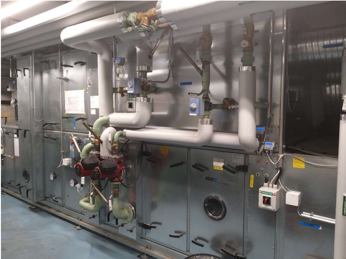
KUVA 6. Ilmastointikone, S-Market nro 1
