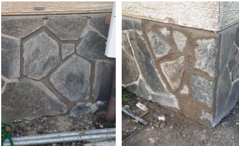
Kuva 12. Asuinrakennuksessa sokkeliperustus korjauksen tarpeessa.
