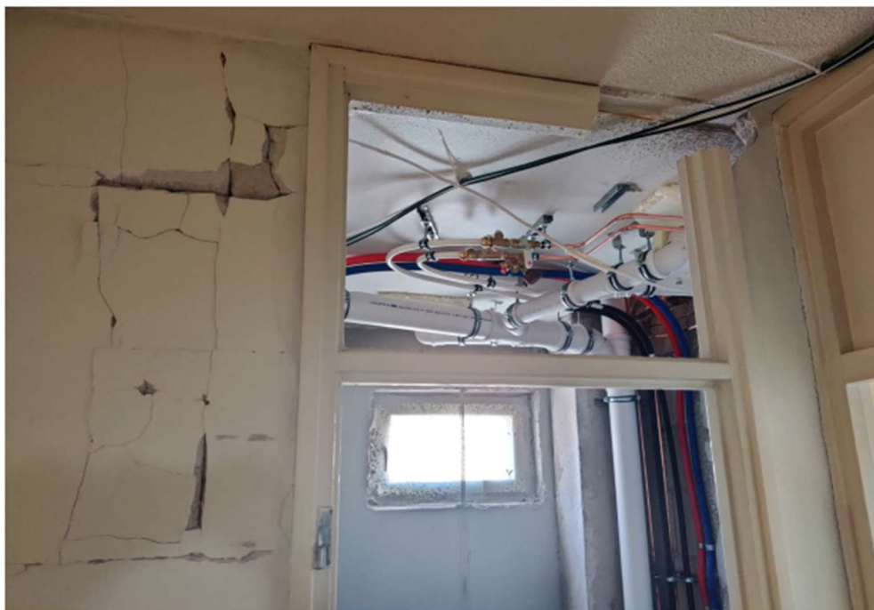
Kuva 6. Kuvassa vasemmalla remontissa seinään syntyneet vauriot.
