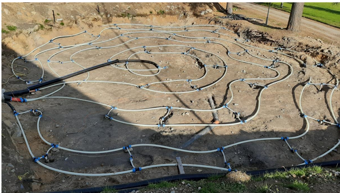
Figur 2. Rörsystem på ytan av ett värmelager.
