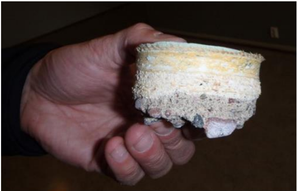
KUVA 19. Betonilattian ja muovimatton välissä asbestipitoisia massakerroksia. (RT – Asbestikartoitus 2016).
