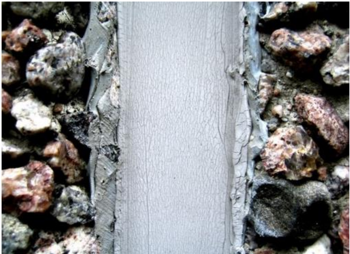
KUVA 21. Vanhaa PCB-pitoista saumausmassaa ei ole poistettu oikeaoppisesti kokonaan ennen uuden saumausmassan asentamista (RT – HAITTA-ainetutkimus 2016).
