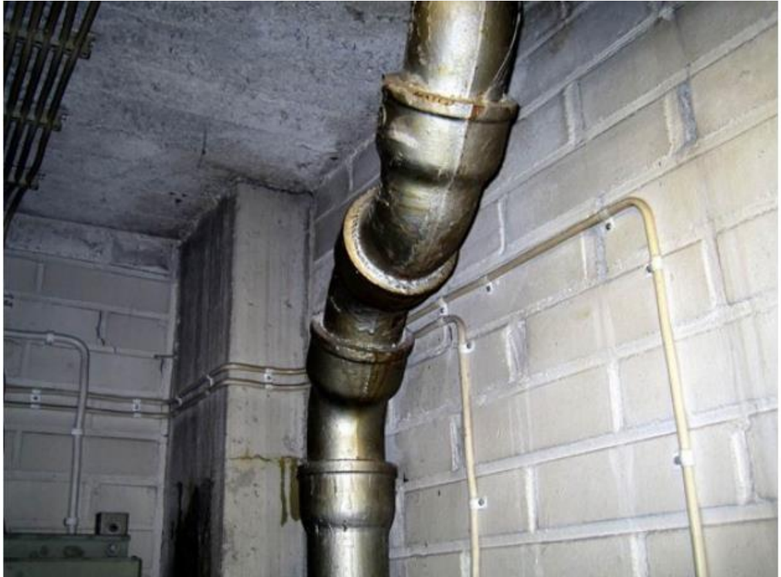
KUVA 17. Valurautaputken liitoksessa lyjyä (RT – haitta-ainetutkimus 2016).
