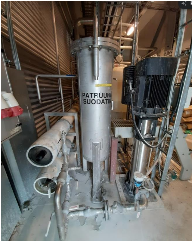
KUVA 17. RO-laitteiston kuoroputket ja korkeapainepumppu
