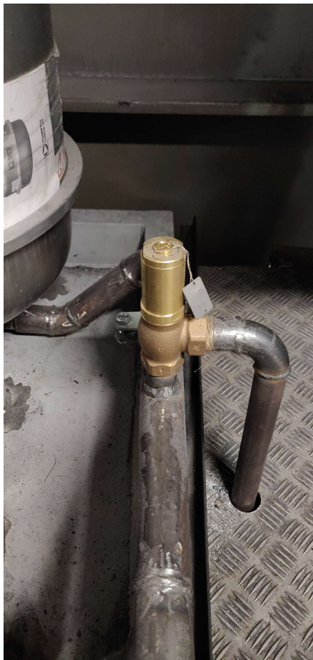
Figur 11 – Övertrycksventil med utlopp ner i golvet som går till spillvattentanken. (Figur 11)
