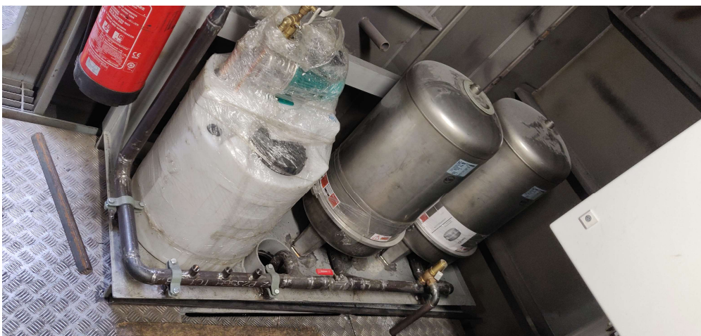
Figur 17 – Station för glykolpåfyllning till systemet med egen pump (vänster) och expansionstankarna (höger). Tillverkare Pumppu Lohja OY. (Figur 18)
