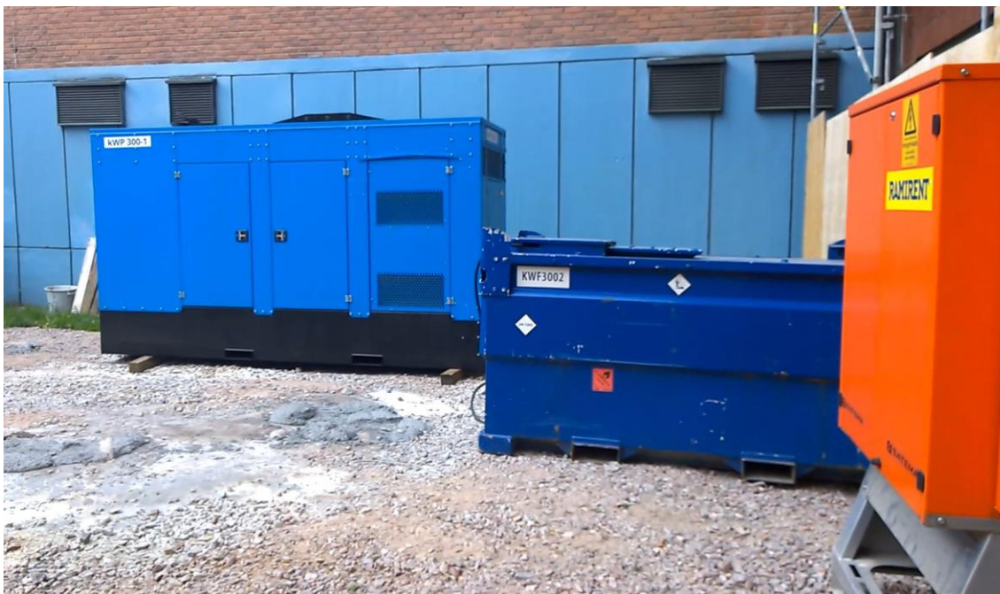
Kuva 8. Dieselgeneraattori lisäpolttoainesäiliöineen ja pienjänniteliittymää varten vuokrattu mitauskeskus asennettiin kiinteistön takapihalle. Laitteiden ympärille tehtiin tilapäinen lauta-aita ilkivaltasuojaksi.
