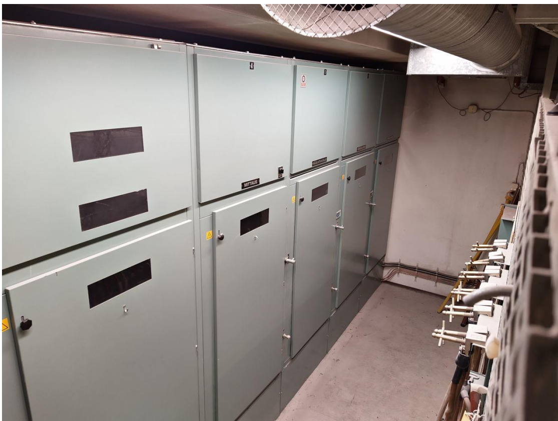
Kuva 20. KOy Mikonkatu 2 – Pohjoisesplanadi 35:n muuntamo.
