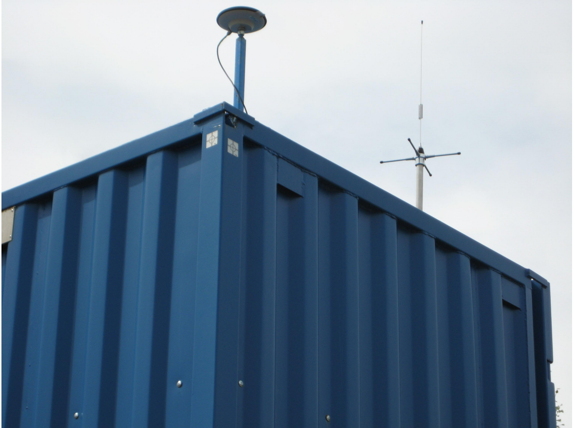
kuva 15. Tukiaseman gps- lautasantenni ja radioantenni.
