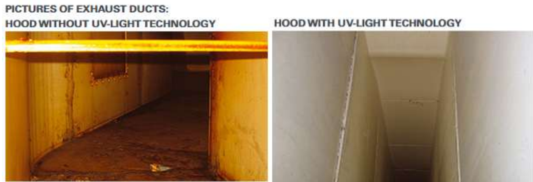
Kuva 8. Huuvan poistoilmakanavisto ilman UV-järjestelmää sekä UV-järjestelmän kanssa [21].
