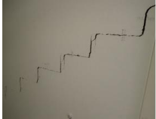
Kuva 9. Halkeama taukokuoneen seinässä.
