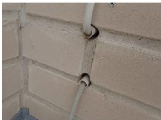
Kuva 10. Julkisivuissa havaittiin tiivistämättömiä läpivientejä.
