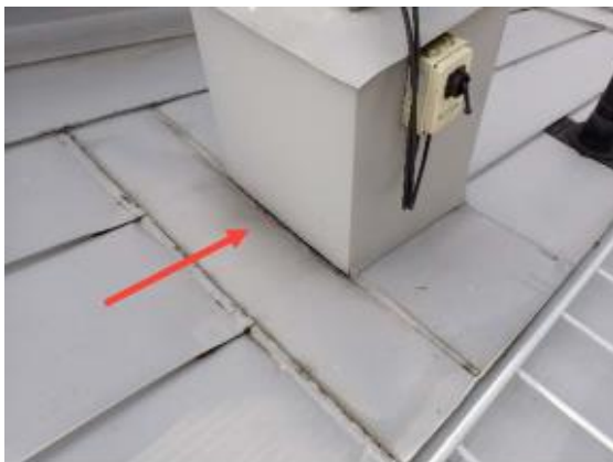
Kuva 12. Suurempien läpivientien kohdalla taustakallistukset ovat puutteelliset.
