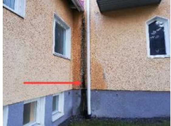
Kuva 5. Vaurioita rappauksessa rakennuksen sisäkulmassa.
