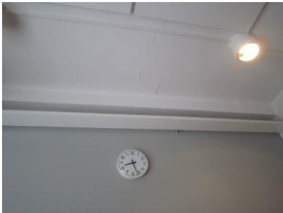
Kuva 18. Liian monen maalikerroksen aiheuttama lohkeilu.
