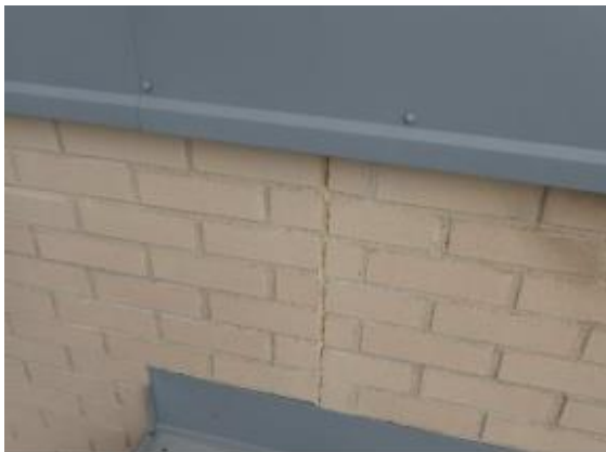
Kuva 11. Julkisivujen elastisessa saumamassassa havaittiin paikoitellen halkeamia.
