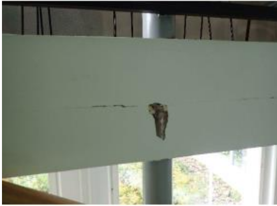
Kuva 8. Halkeamia porrashuoneen välitasanteessa
