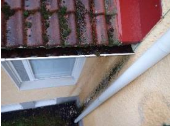
Kuva 6. Vesikouruissa havaittiin runsaasti roskaa.
