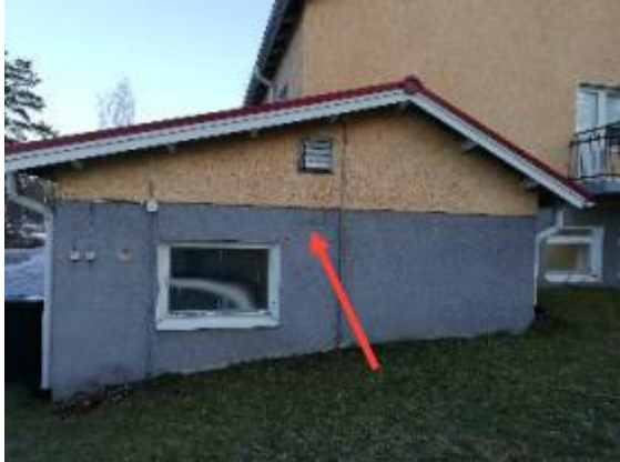
Kuva 4. Eteläisellä julkisivulla havaittiin halkeamia ikkunoiden ylä- ja alapuolella.
