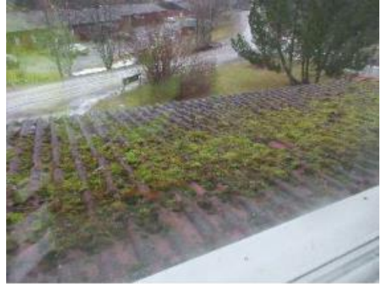
Kuva 7. Tiilikatteen päällä havaittiin sammalkasvustoa.
