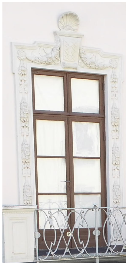
Kuva 75 Pääsisäänkäynnin yläpuolisen parvekkeen ovi. Arkkitehtitoimisto Hanna Lyytinen Oy
