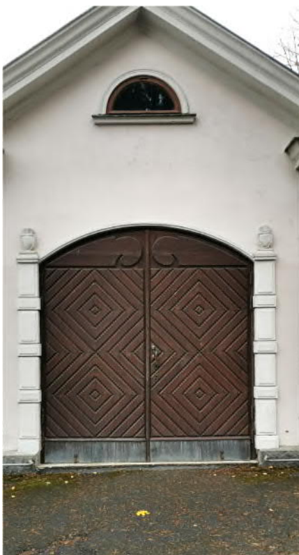
Kuva 76 Autotallin ovi. Arkkitehtitoimisto Hanna Lyytinen Oy
