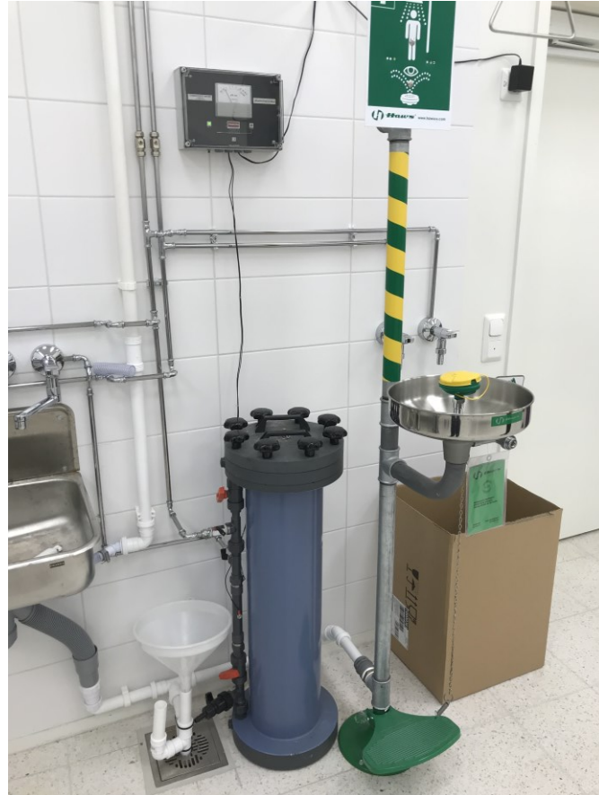
Kuva 2 Oppilaitoksen yksialustainen ioninvaihtaja.
