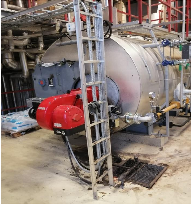
KUVA 3. Höyrykattila ja nestekaasupoltin
