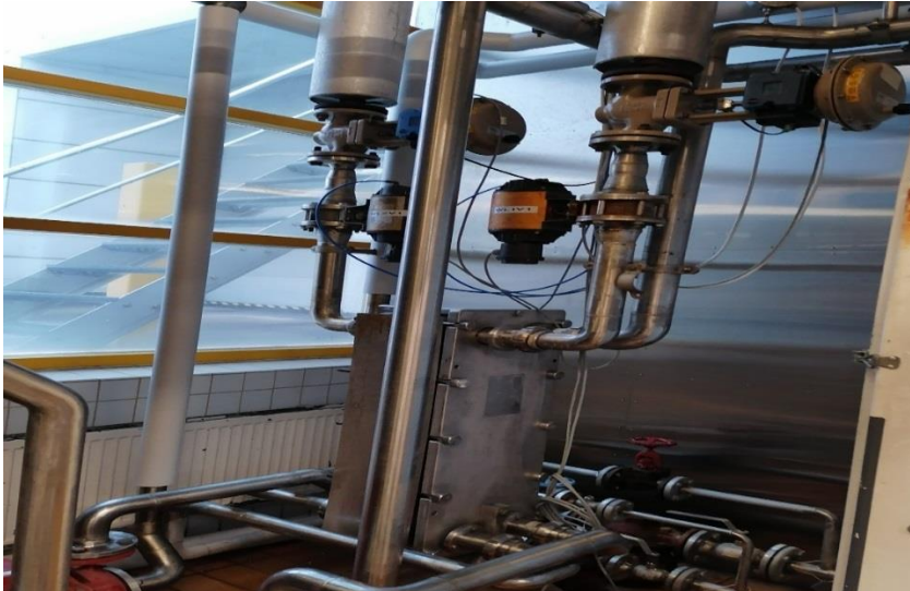
KUVA 11. Säiliöiden lämmityksen levylämmönsiirrin
