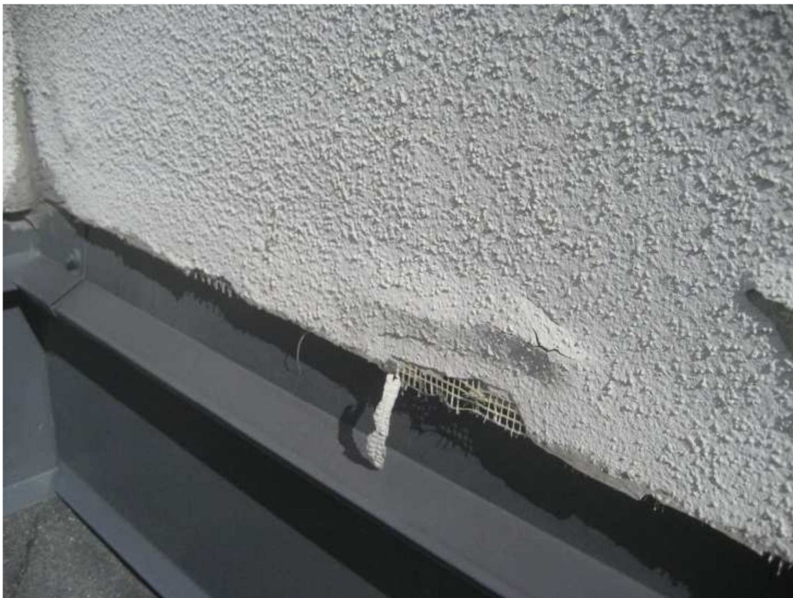
Kuva 62. Ohutrappauksen pakkasrapautumista vesikaton yläpuolisella osuudella. Kuva: Juha Räisänen 2018.
