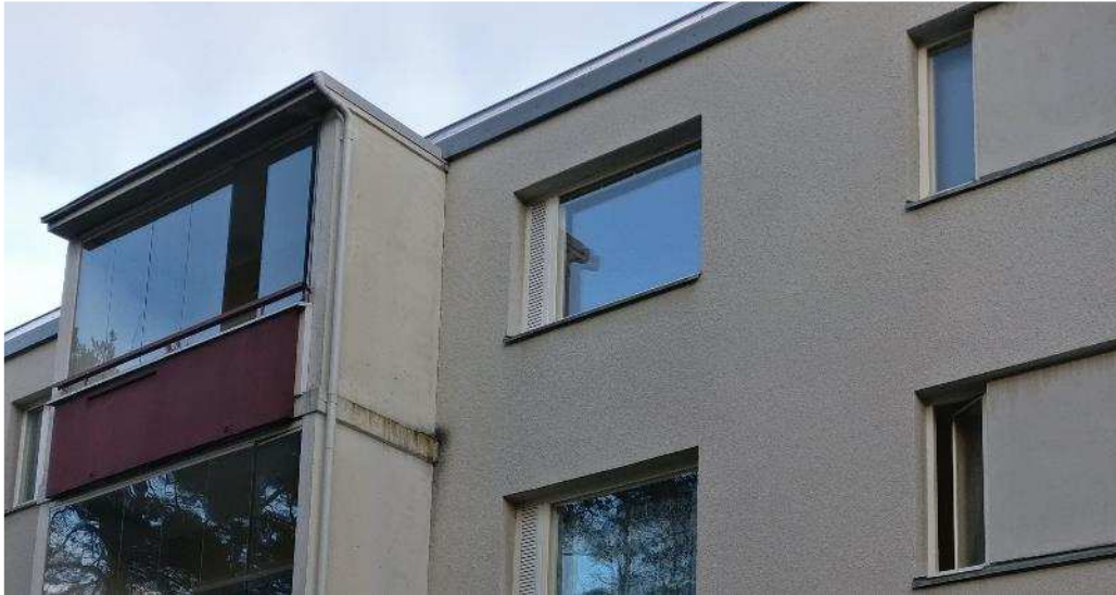
Kuva 44. Paksurappaus on likaantunut parvekelaatan kohdalta, parvekelaatta muodostaa hyllyn laatan ja pielen välille. Kuva: Matti Eronen 2018.
