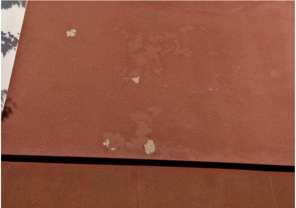
Kuva 49. Pintalaastin sekä mahdollisesti erillisen pinnoitekerroksen hilseilyä. Kuva: Matti Eronen 2018.
