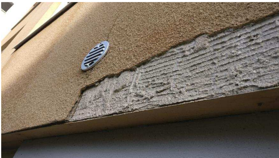
Kuva 71. Rappaus lohjennut sokkeliliittymän yläpuolella. Kuva: Matti Eronen 2018.
