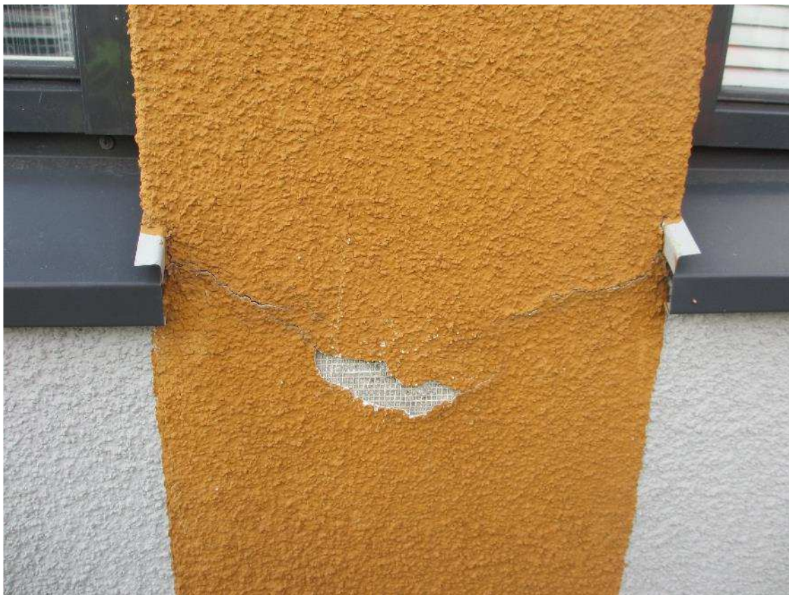
Kuva 31. Diagonaalisuuntaiset halkeamat ikkunoiden nurkkien kohdalla, rapautumaa halkeamien keskellä. Kuva: Matti Eronen 2016.
