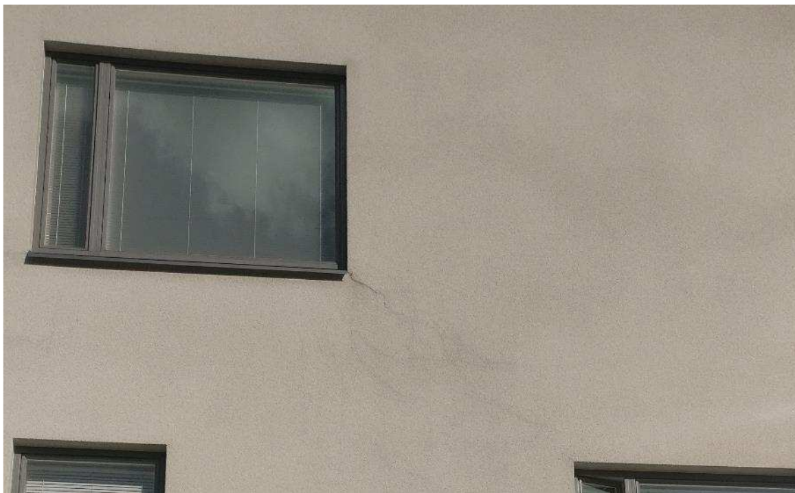
Kuva 11. Ikkunan vesipeltiliittymän kohdalla diagonaalihalkeama ja pakkasrapautumaa. Kuva: Matti Eronen 2018.
