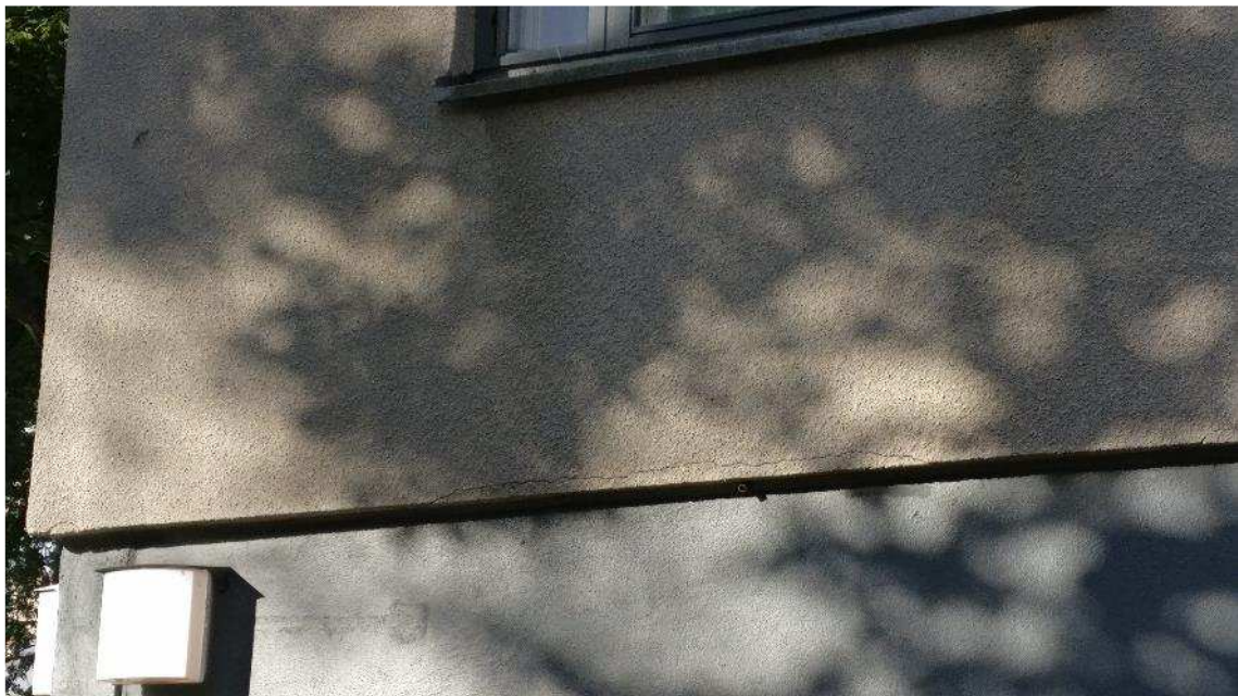
Kuva 34. Paksurappauksen vaurioitunut sokkeliliittymä. Kuva: Matti Eronen 2018.
