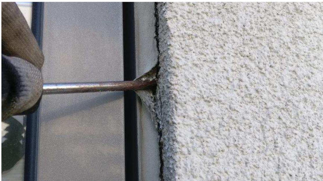
Kuva 25. Ohutrappauksen liitos porrashuoneen lasiseinään on tehty väärän tyyppisellä saumamassalla, tartunta irronnut ohutrappauksen pinnasta. Kuva: Matti Eronen 2019.
