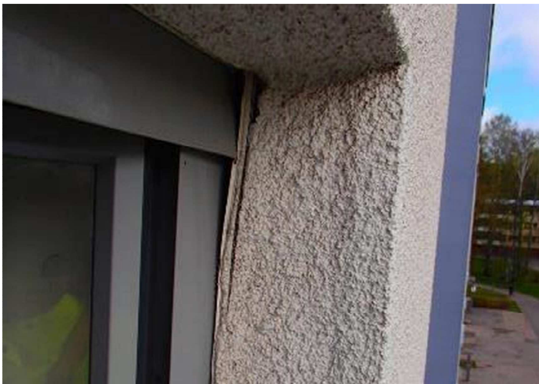
Kuva 10. Ikkunan karmin alumiiniprofiilien liittymä on avoin, vaurio aiheutunut myös rappausliittymään. Kuva: Matti Eronen 2019.
