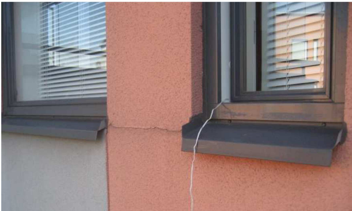
Kuva 61. Vaakasuuntainen halkeama kapeahkossa kannaksessa ikkunoiden välissä. Kuva: Juha Räisänen 2016.
