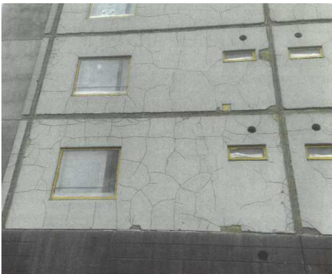
Kuva 51. Paksurappauselementtien ulkopinnan halkeilua. Kuva: Mattila
