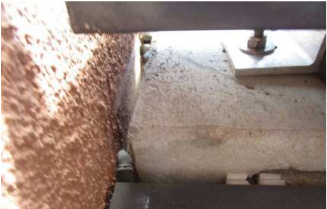
Kuva 16. Parvekelaatan ja ohutrappauksen välinen liittymä on avoin. Kuva: Santtu Suvanen 2018.
