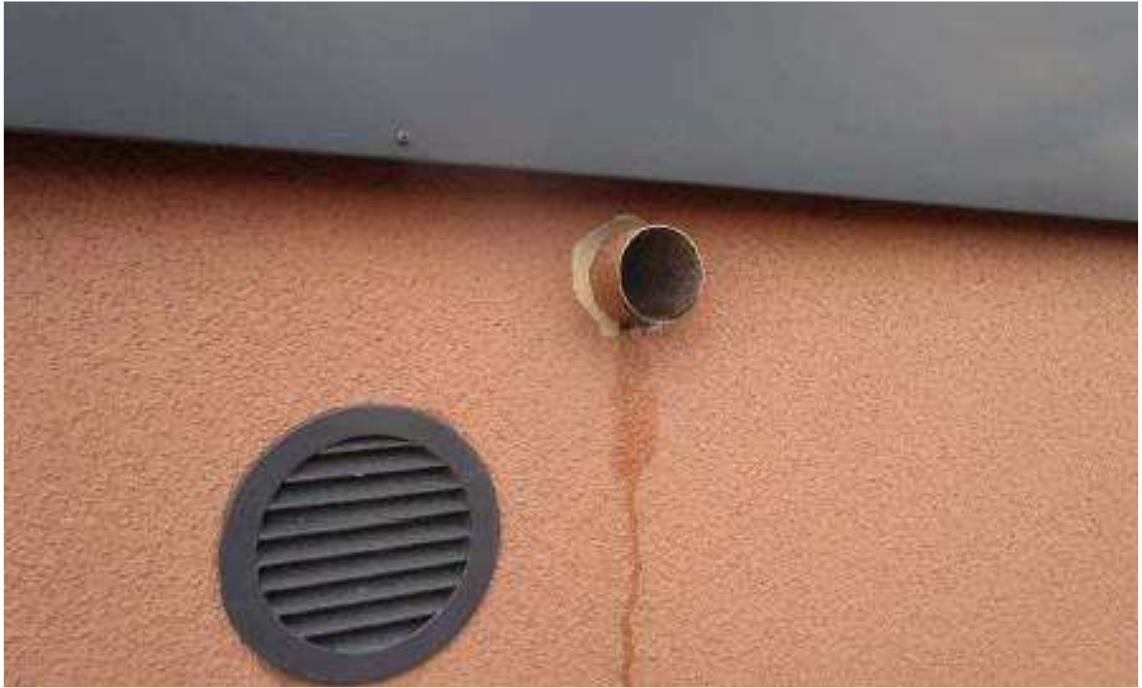
Kuva 28. Yläpohjarakenteen vedenpoistoputki on lyhyt. Kevyen sateen vähäiset vesimäärät valuvat suoraan rappauspinnalle. Kuva: Santtu Suvanen 2018.
