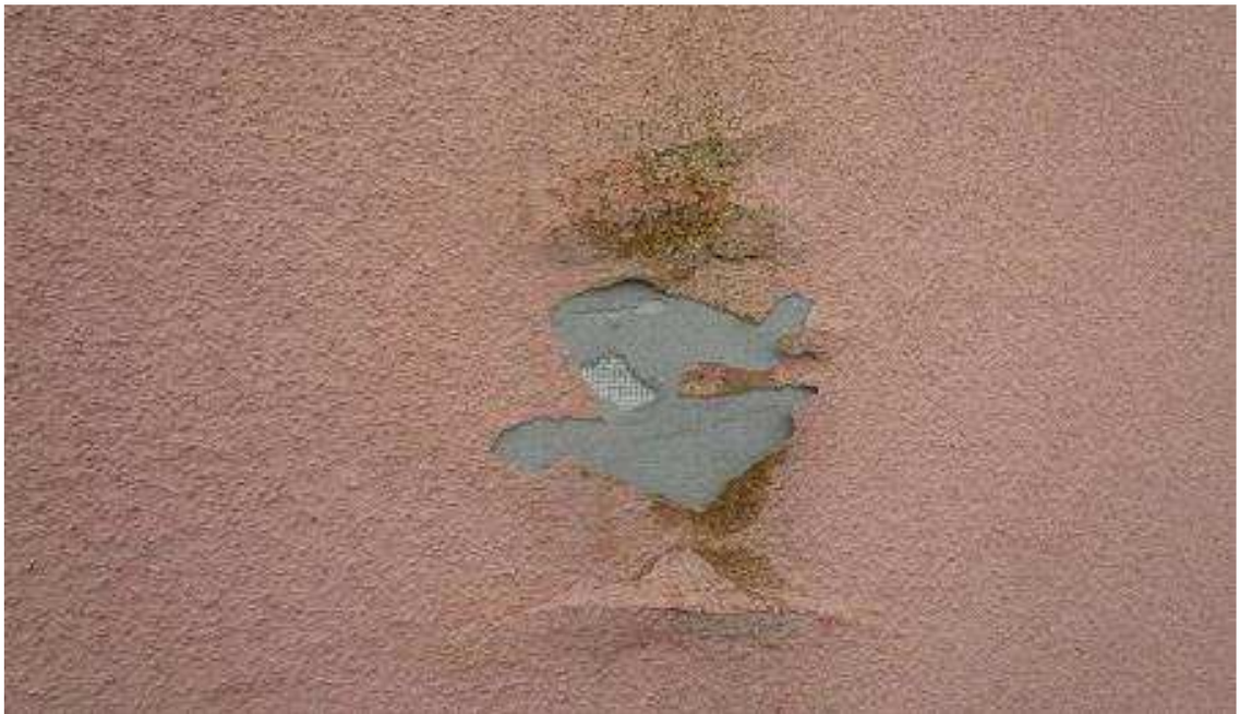
Kuva 29. Rappauspinnalle valuva vesi on vaurioittanut rappaista. Kuva: Santtu Suvanen 2018.
