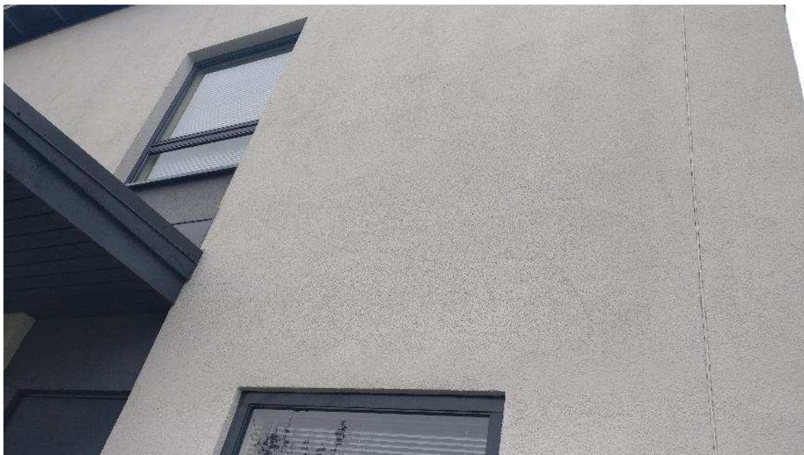
Kuva 69. Vaakasuuntainen halkeama ikkunan yläpuolella, ikkunan ja vaakahalkeaman välissä suuntautumattomia halkeamia. Kuva: Matti Eronen 2018.
