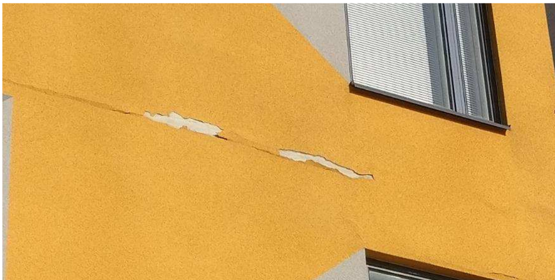
Kuva 15. Halkeama ja pinnoitteen sekä verkotuslaastikerroksen irtoamista elementtisauman kohdalla. Kuva: Matti Eronen 2018.
