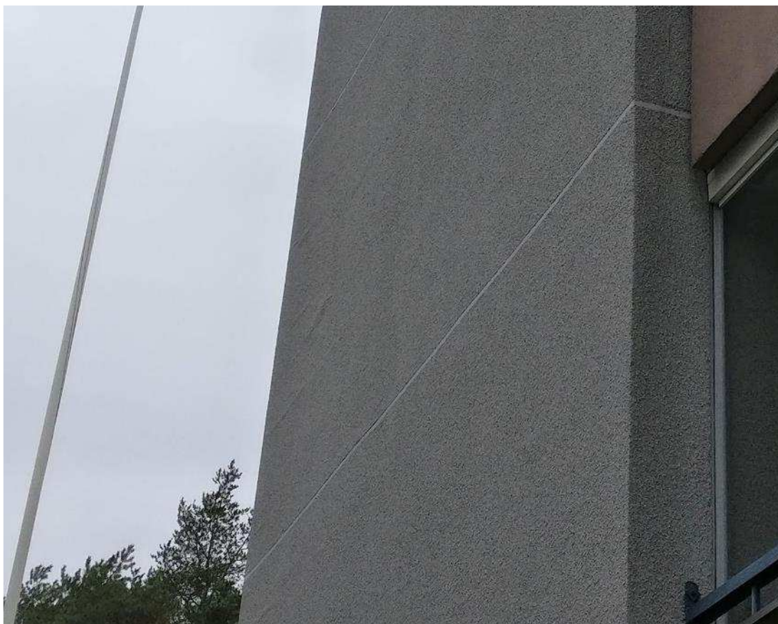
Kuva 32. Ohutrapatussa julkisivussa on nähtävissä lämmöneristeen saumajaon mukaista vaurioitumista. Kuva: Matti Eronen 2018.
