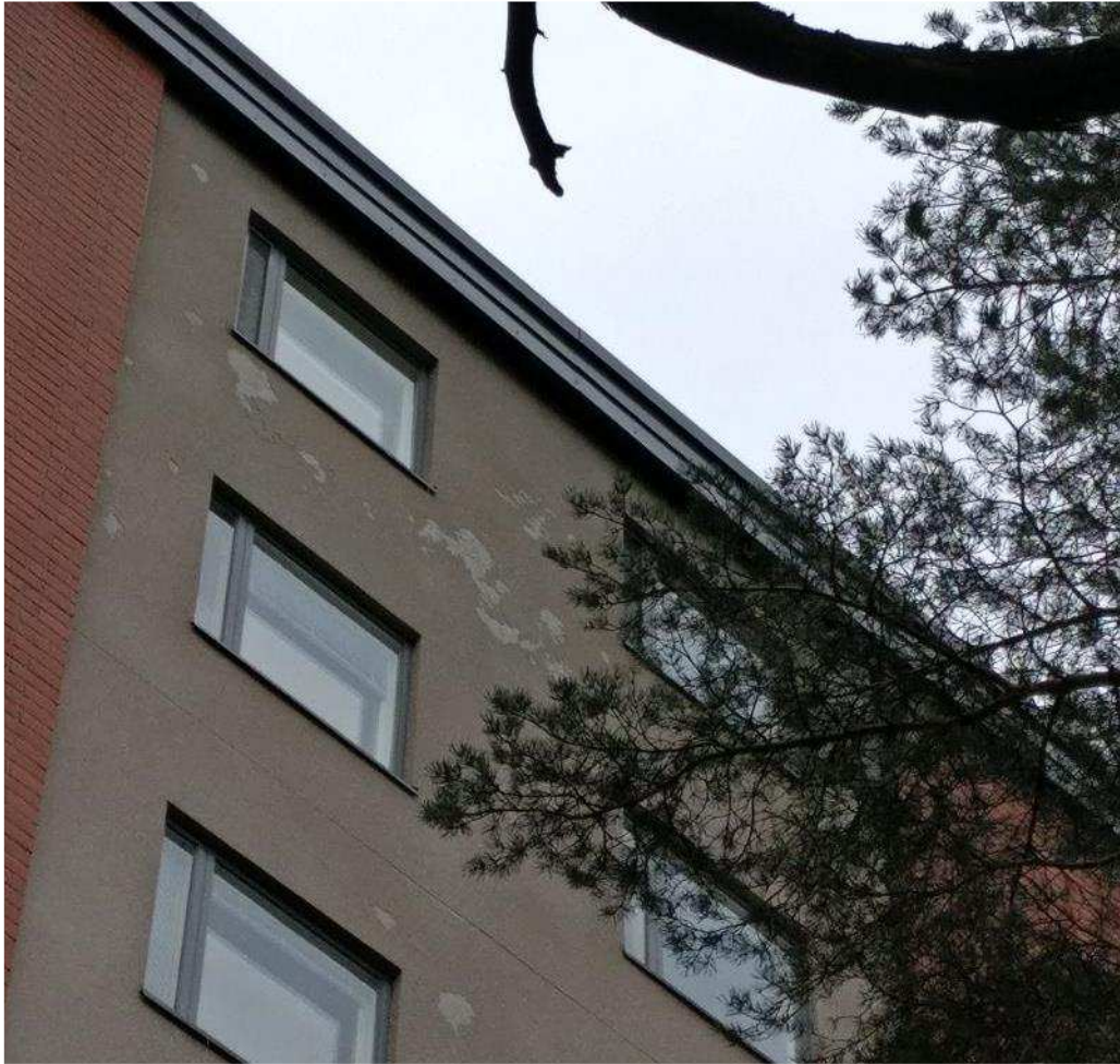
Kuva 50. Kuva: Matti Eronen 2018. Rappauspinnan lohkeilua julkisivujen yläosissa.
