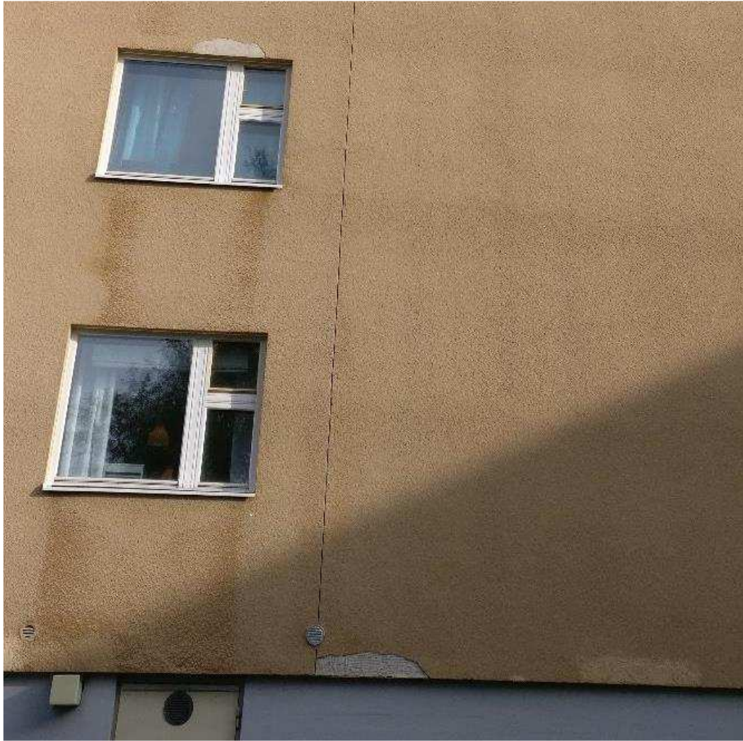
Kuva 46. Vesipeltien alapuolelle on jäänyt valumajäljet. Kuva: Matti Eronen 2018.
