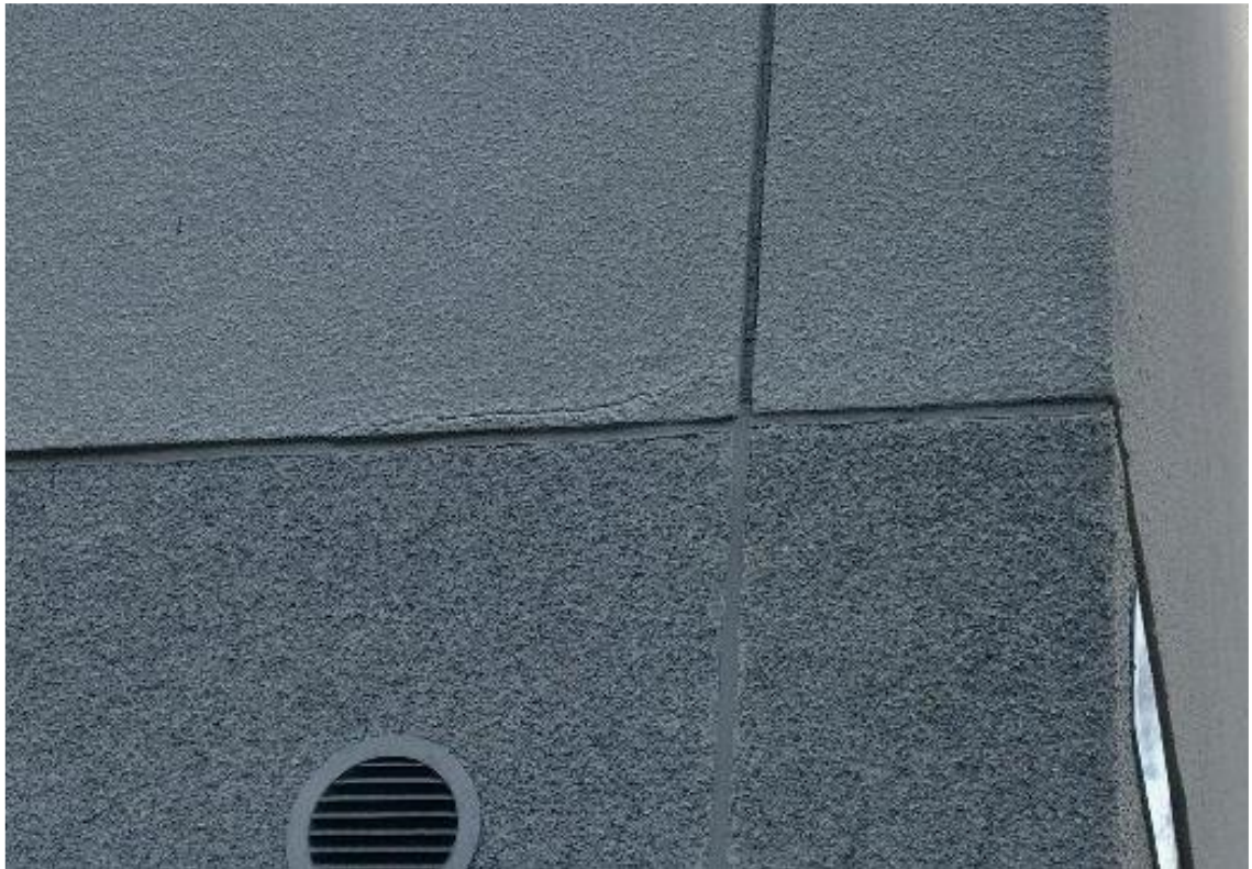
Kuva 33. Paksurappauksen vaurioitumista sokkelin kohdalla. Kuva: Matti Eronen 2018.
