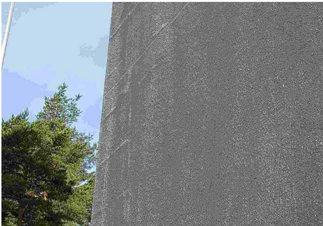
Kuva 65. Levyjako näkyvissä rapautuneella eteläjulkisivulla. Kuva: Matti Eronen 2018.
