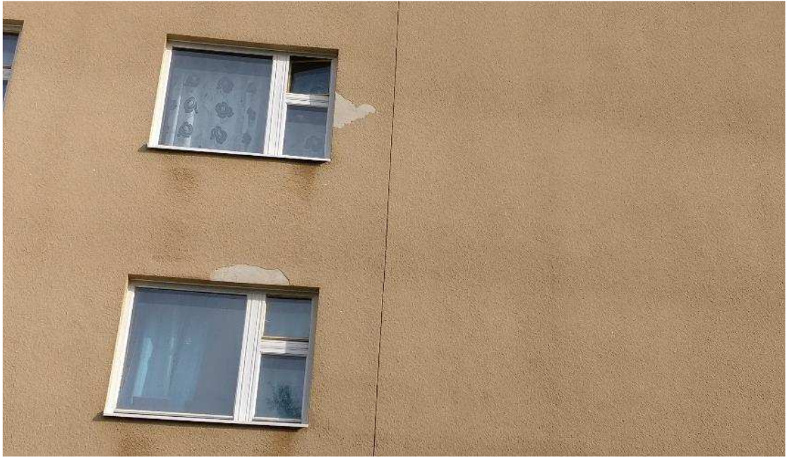
Kuva 35. Rappausvaurioita ikkunaliittymissä. Kuva: Matti Eronen 2018.
