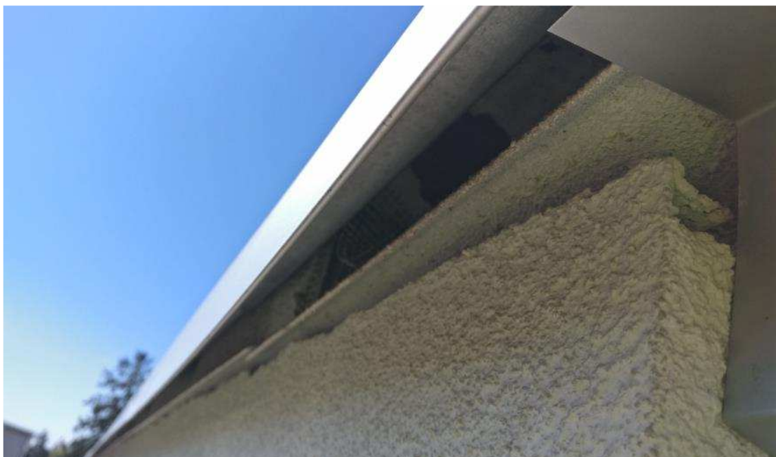
Kuva 13. Yläräystäään liittymä myrskypellin ja päättölistan välistä auki. Kuva: Matti Eronen 2019.
