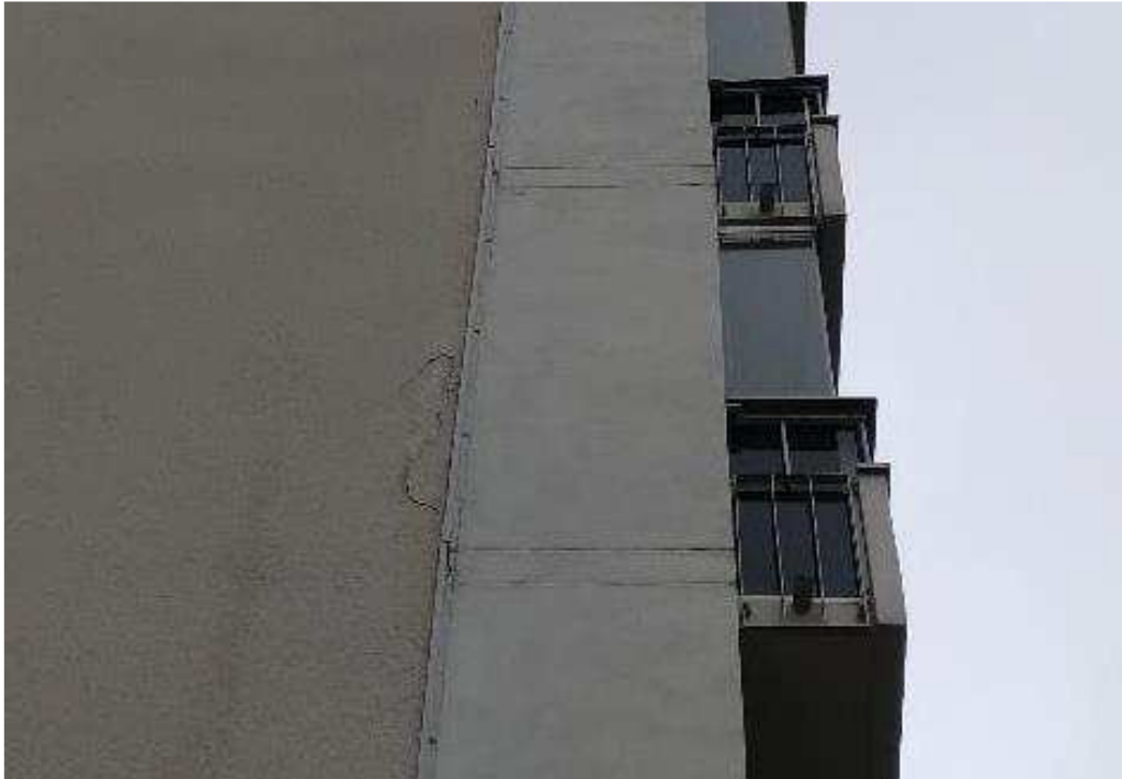
Kuva 43. Parvekepielen ja rappauksen liittymässä ei ole alun perin ollut riittävää liikevaraa. Liittymä on jälkikäteen pellitetty. Kuva: Matti Eronen 2018.
