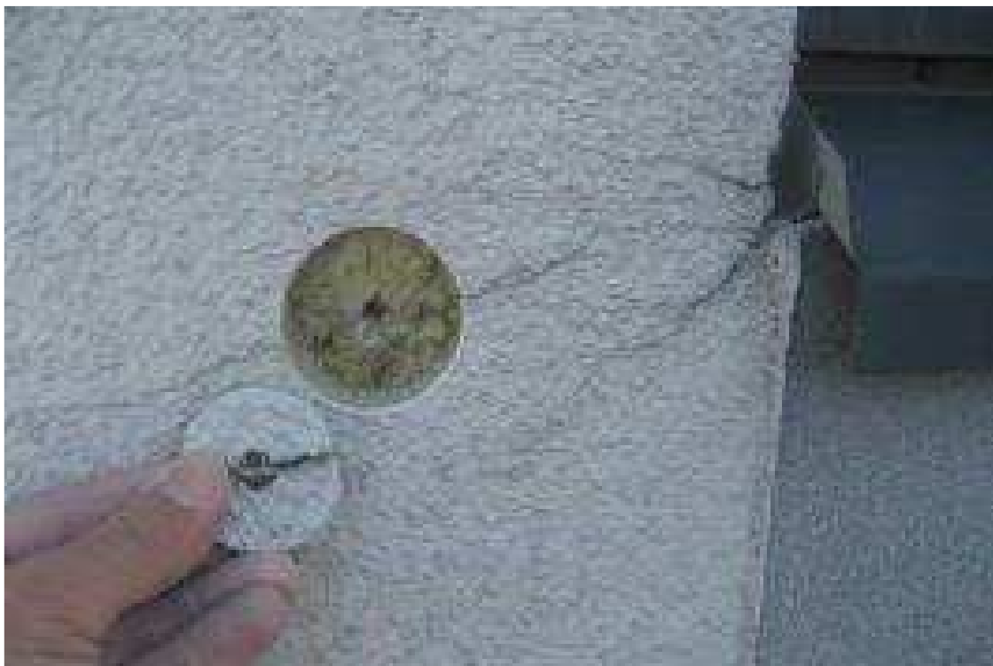
Kuva 60. Näyteporaus kohteessa B4 halkeamavaurion kohdalta. Alueella ei diagonaalisuuntaista kulmaverkkoa. Kuva: Juha Räisänen 2016.
