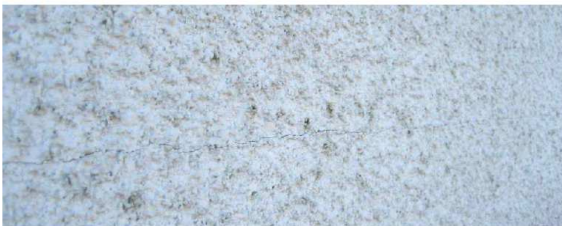
Kuva 67. Vaakasuuntainen halkeama rappauksessa. Kuva: Arja Pekkala 2014.
