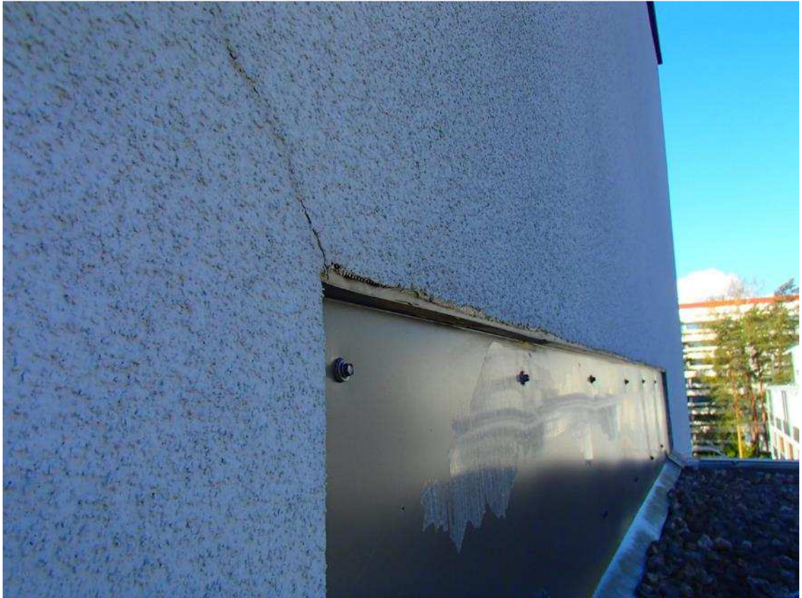
Kuva 21. Vedeneristekermin suojapellityksen ja ohutrappauksen liitos on jäänyt puutteelliseksi. Kuva: Matti Eronen 2018.
