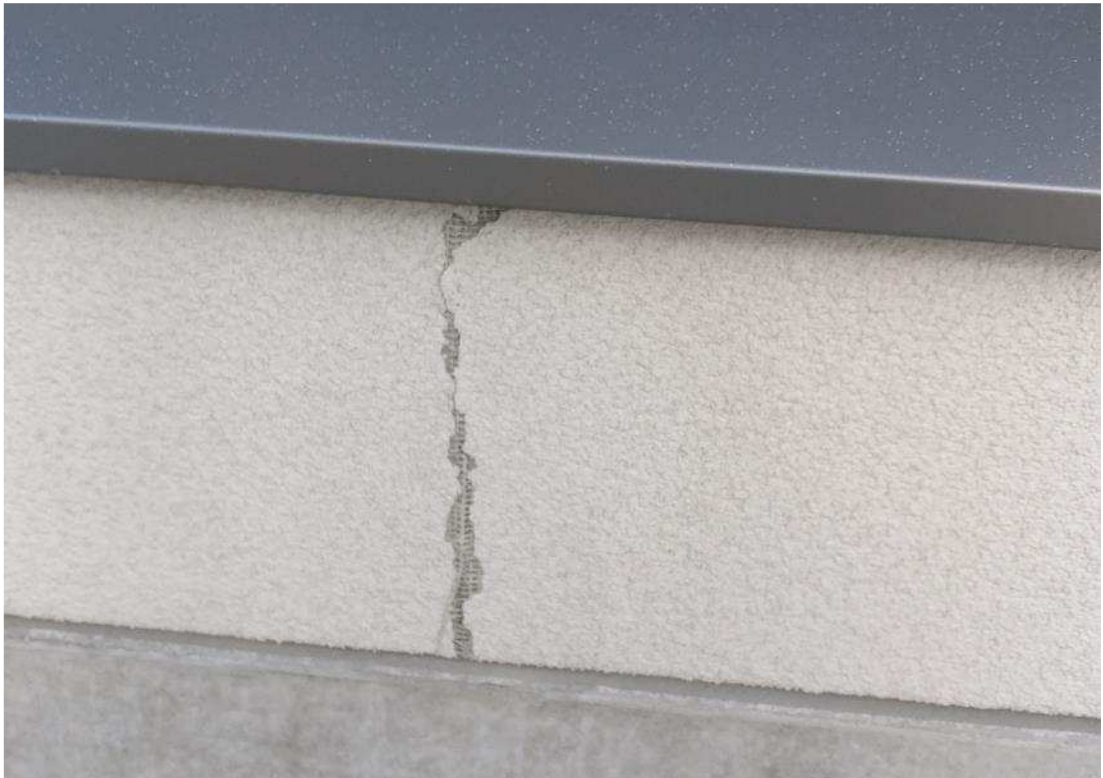
Kuva 30. Matalahkoon rappauskannakseen on syntynyt halkeama. Kuva: Matti Eronen 2018.
