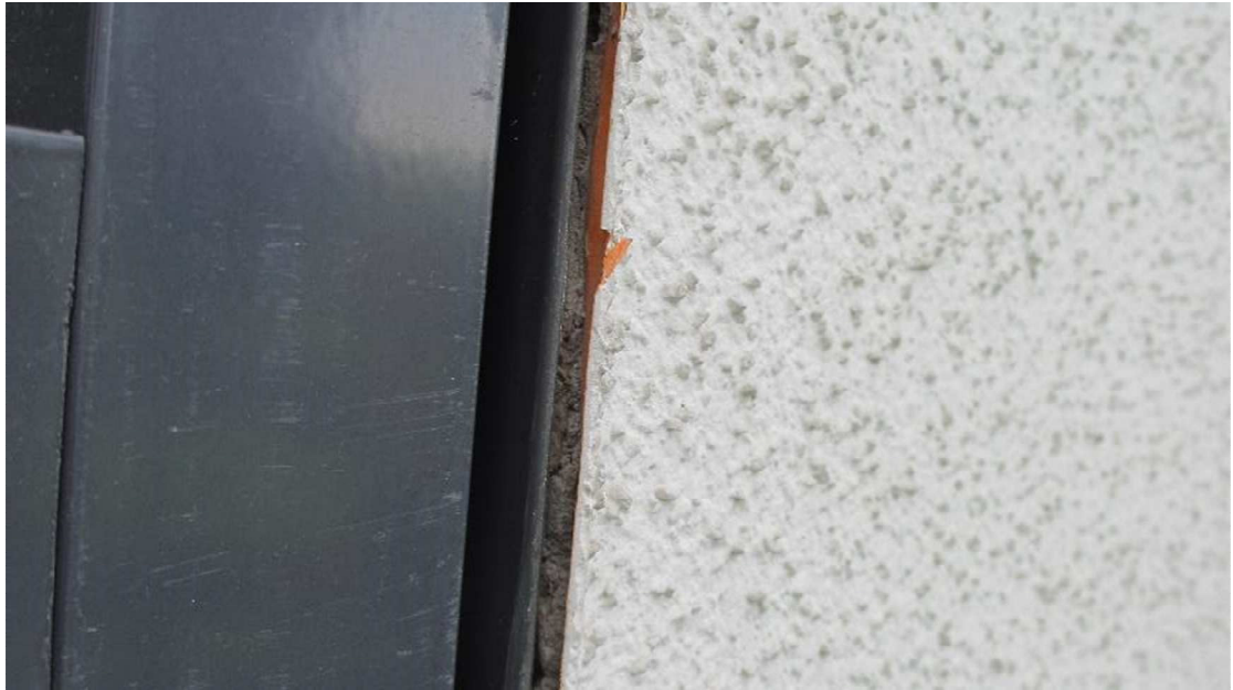
Kuva 24. Ohutrappauksen ja porrashuoneen lasiseinän liitos on avoin. Kuva: Matti Eronen 2017.
