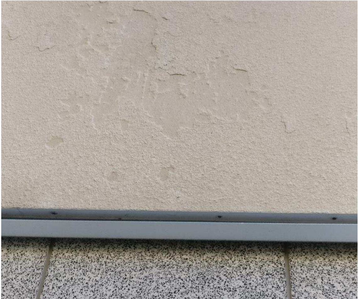
Kuva 48. Pintalaastin irtoamista sokkeliliittymän yläpuolella. Kuva: Matti Eronen 2018.
