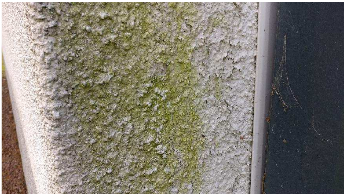
Kuva 47. Paksurappauksen pinnoite hilseilee irti. Kuva: Matti Eronen 2018.
