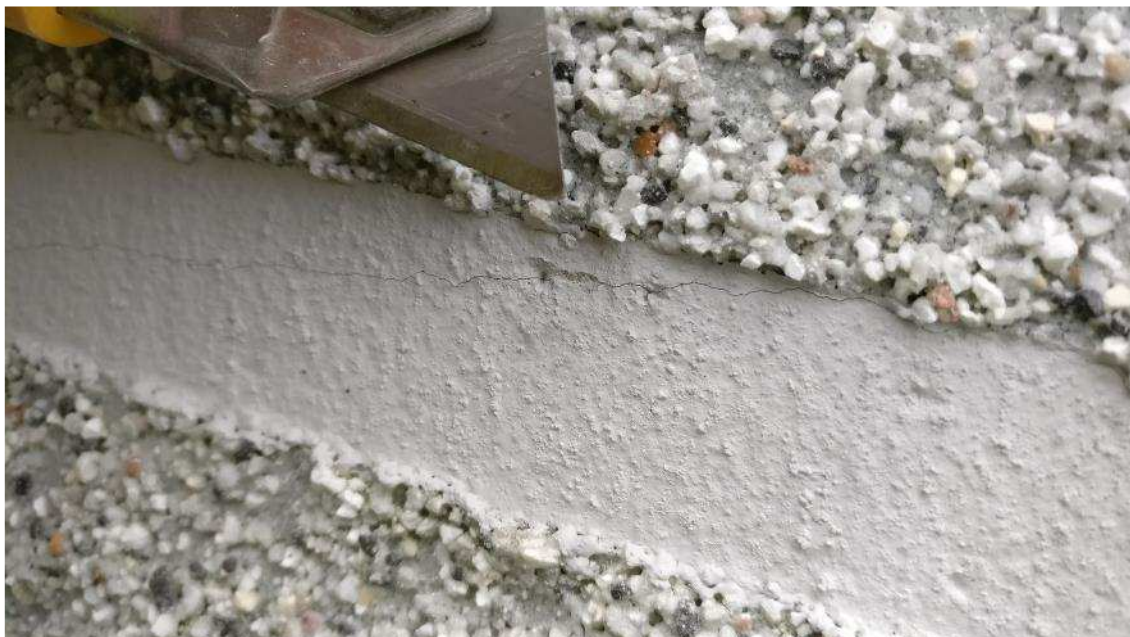
Kuva 23. Hiushalkeama ohutrappauksen valesaumassa. Kuva: Matti Eronen 2018.
