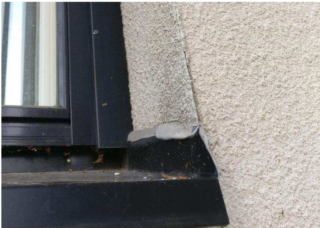
Kuva 36. Pielipellityksen ja rappauksen välissä on rako, pellityksissä ei liikevaraa. Kuva: Matti Eronen 2018.
