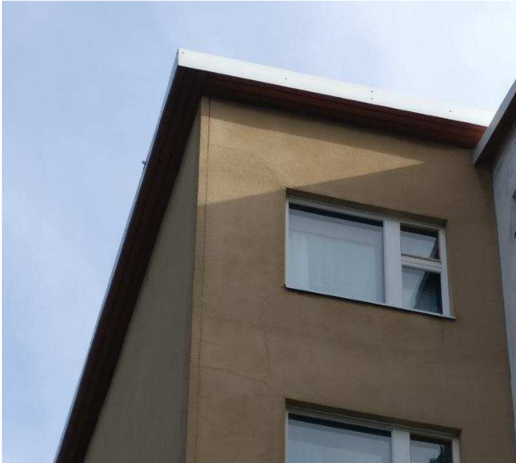
Kuva 41. Halkeilua pystysuuntaisen liikuntasauaman kohdalla. Kuva: Matti Eronen 2018.
