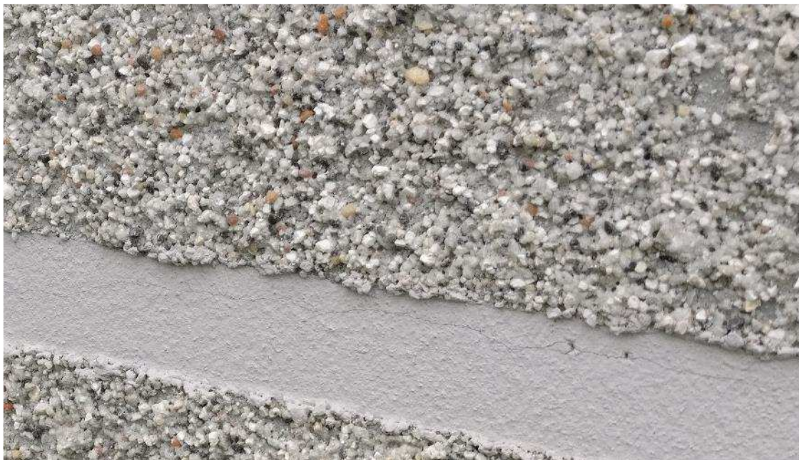
Kuva 64. Lähikuva pohjoisjulkisivun hiushalkeamasta. Kuva: Matti Eronen.
