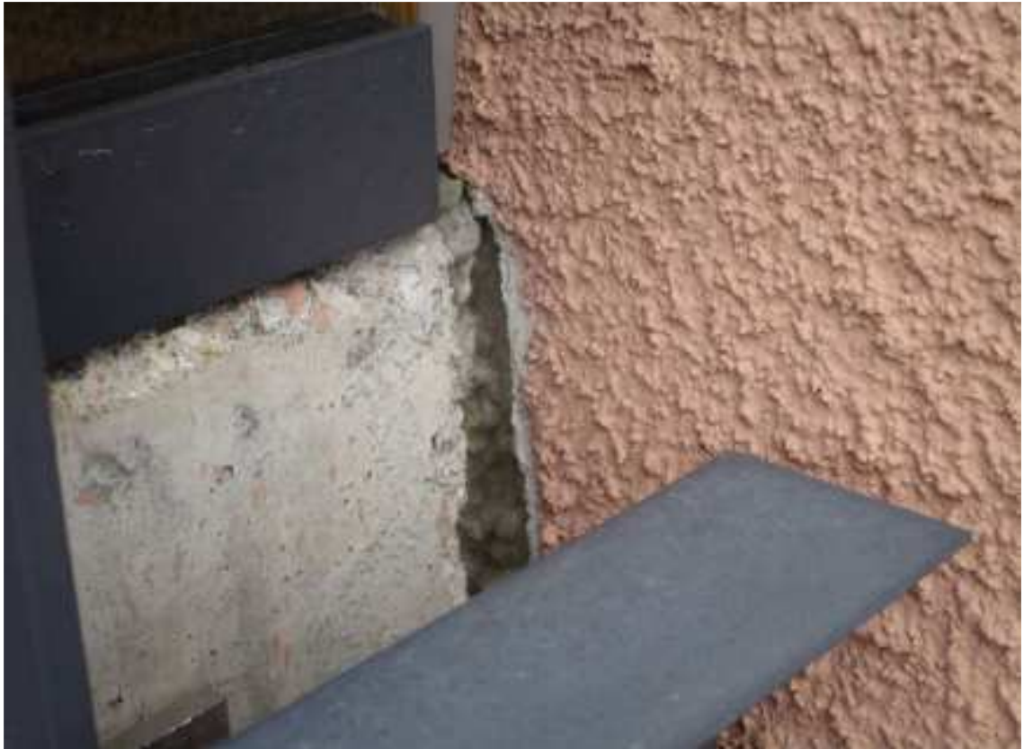
Kuva 17. Parvekelaatan ja eristerappauksen liittymä on jäänyt avoimeksi, ulokeparveke. Kuva: Santtu Suvanen 2018.
