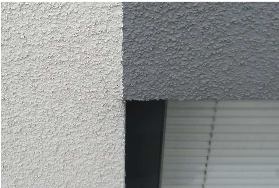
Kuva 9. Hiushalkeama ikkunan yläkulmassa. Kuva: Matti Eronen 2018.
