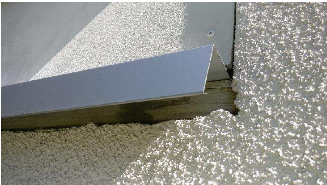
Kuva 27. Ohutrappauksen liitos levy pintaiseen julkisivuosuuteen on jäänyt avoimeksi. Kuva: Matti Eronen 2019.
