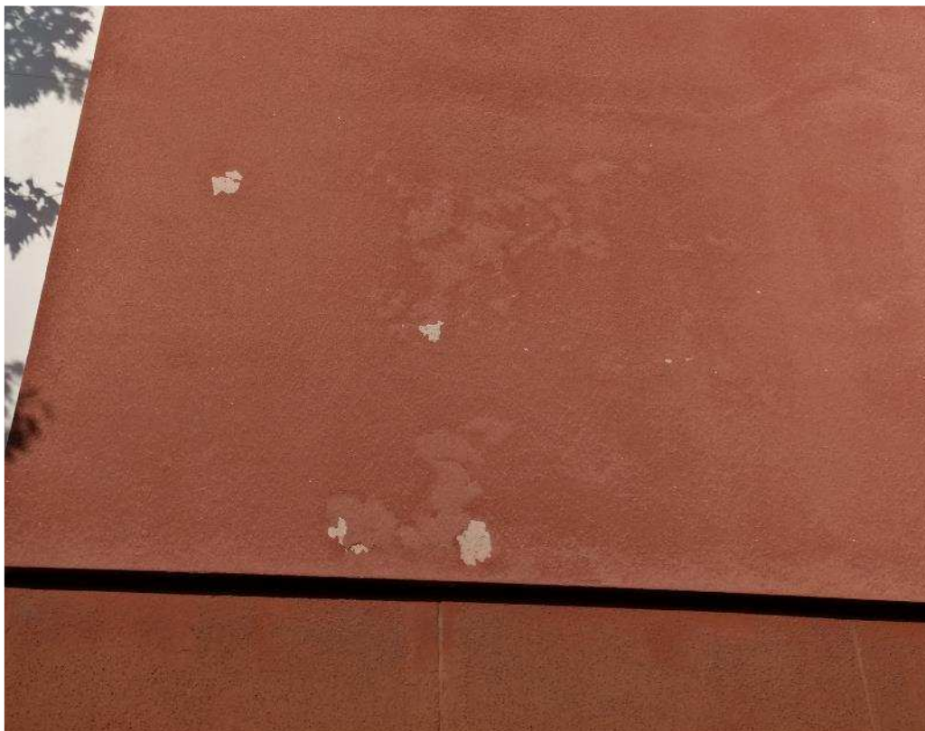
Kuva 72. Pintarappauksen hilseilyä ja täyttörappauksen lohkeilua. Kuva: Matti Eronen 2018.
