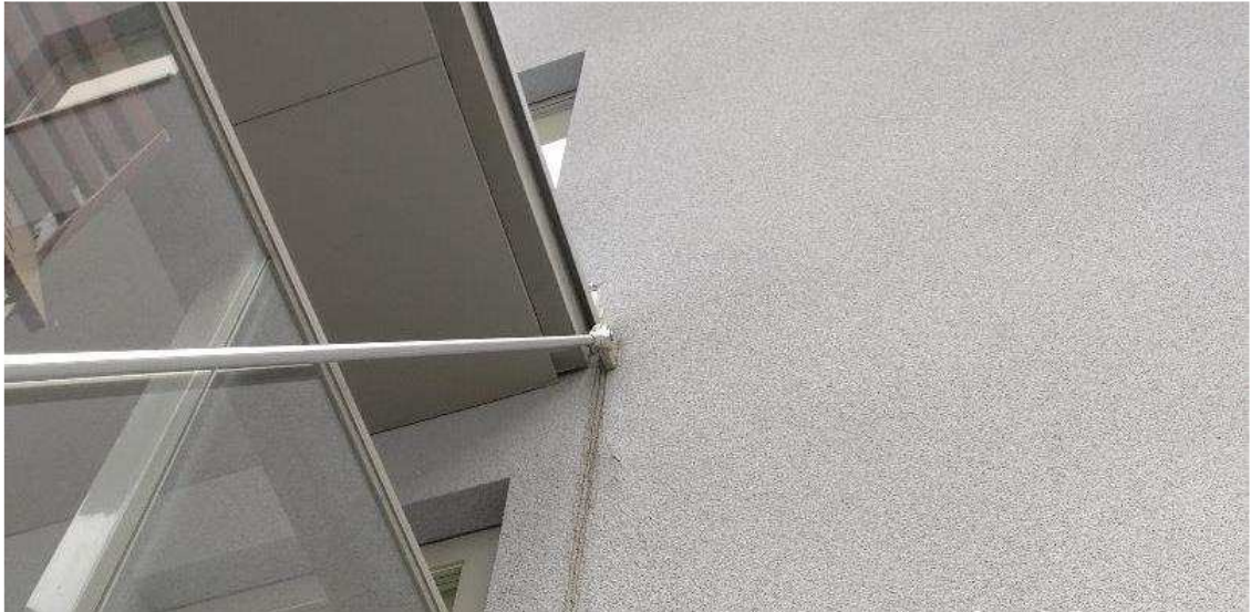
Kuva 18. Parvekekaton ja diagonaalikannattimen väliin on jäänyt kapea rappauskaista. Kuva: Matti Eronen 2018.
