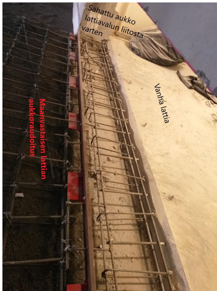
Kuva 7. Seinäsahauksesta ja lattia liitoksesta kuva
