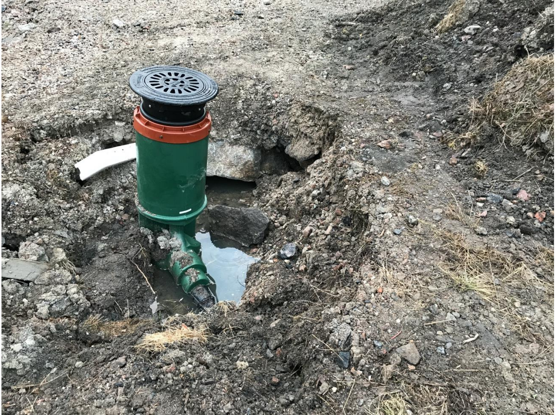
Kuva 9. Teleskoopilla varustettu sadevesikaivo Turun Hirvensalossa.
