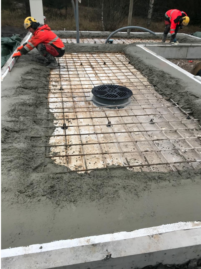
Kuva 8. Autotallin öljynerotuskaivo Liedossa.
