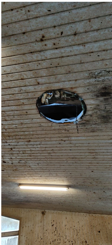
KUVA 26. Rikkoutunut poistohormi (Katainen 2020-03-05.)
