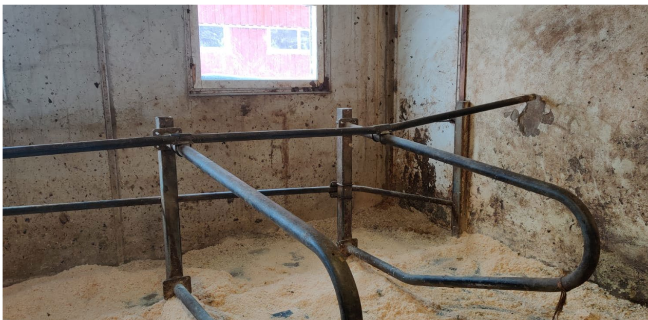
KUVA 17. Vääntyneitä parsikalusteita (Katainen 2020-03-05.)
