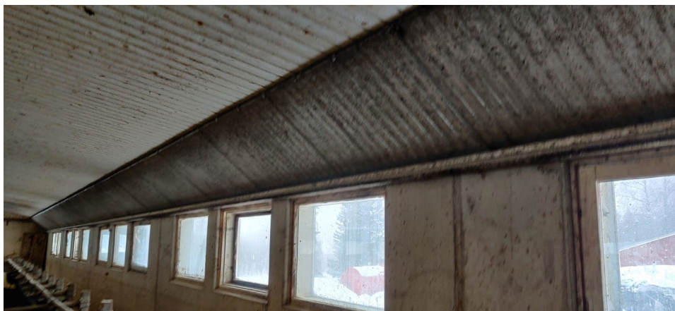
KUVA 24. Sisäkaton reunalla olevia itkupintoja (Katainen 2020-03-05.)
