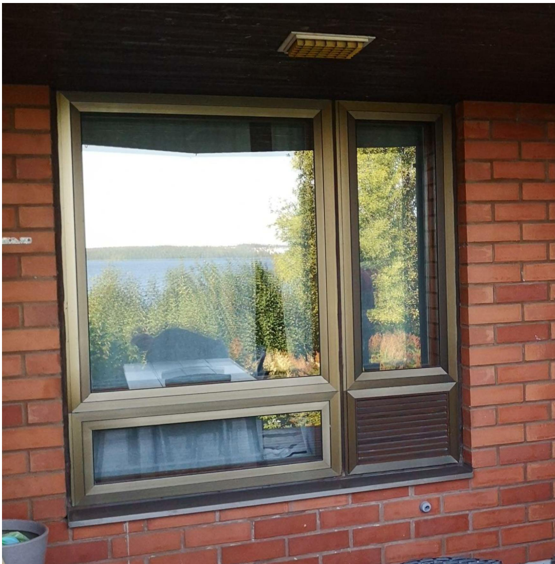
Kuva 25. Pohjoisjulkisivun ikkuna parvekkeen alapuolella. Ikkunanpuitteet olivat eloksoitua alumiinia (Kuva: A-Insinöörit Suunnittelu Oy)
