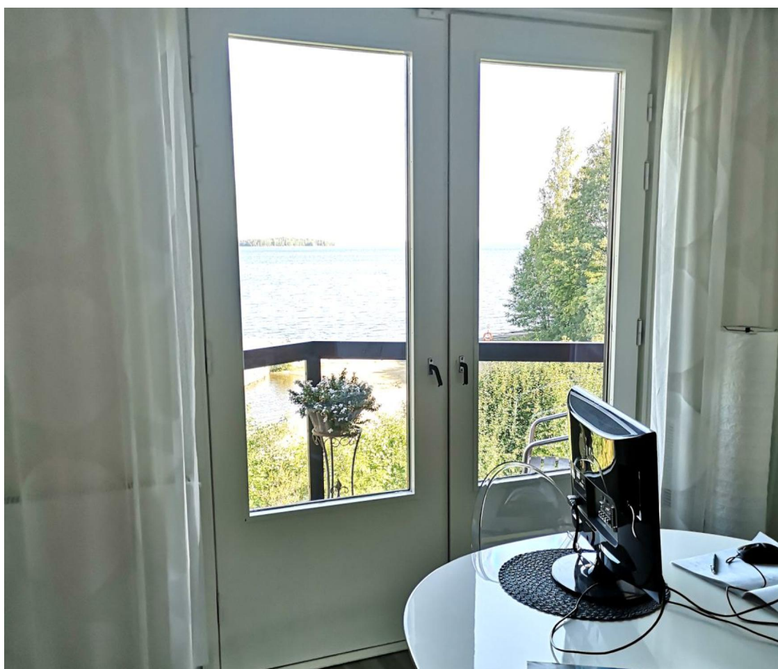
Kuva 5. Vanha parvekeovi ja parvekkeen kaide (Kuva: A-Insinöörit Suunnittelu Oy)
