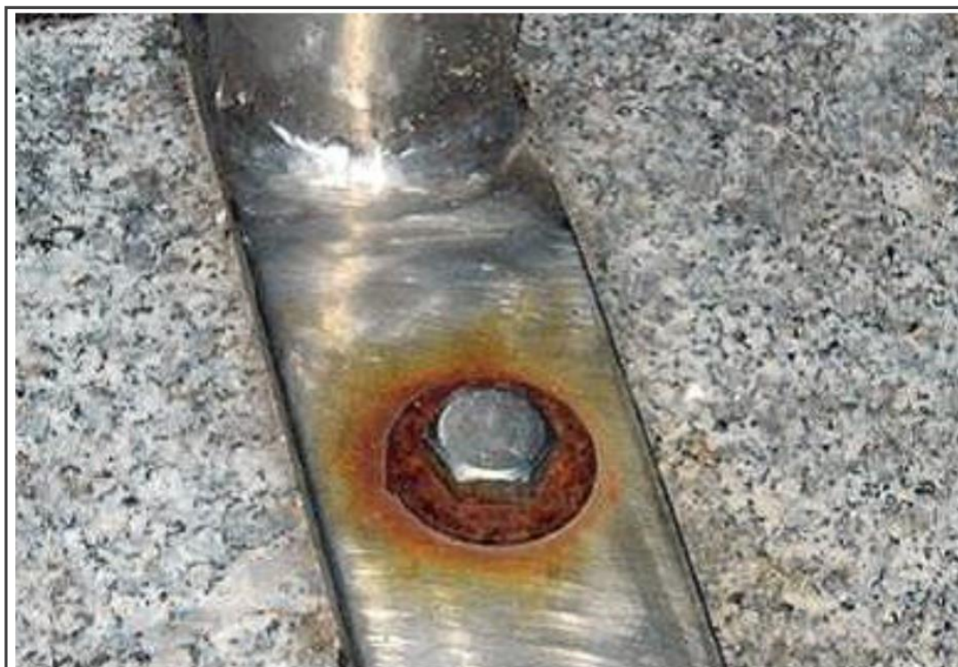
Kuva 3. Galvaaninen korroosio ruostumattoman teräksen ja hiiliteräksen välillä (In-oxmare www-sivut 2020)
