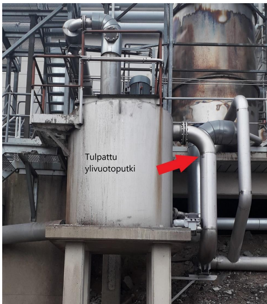
Kuva 8. Kertopuutehtaan LTO:jen keräyskaivo.
