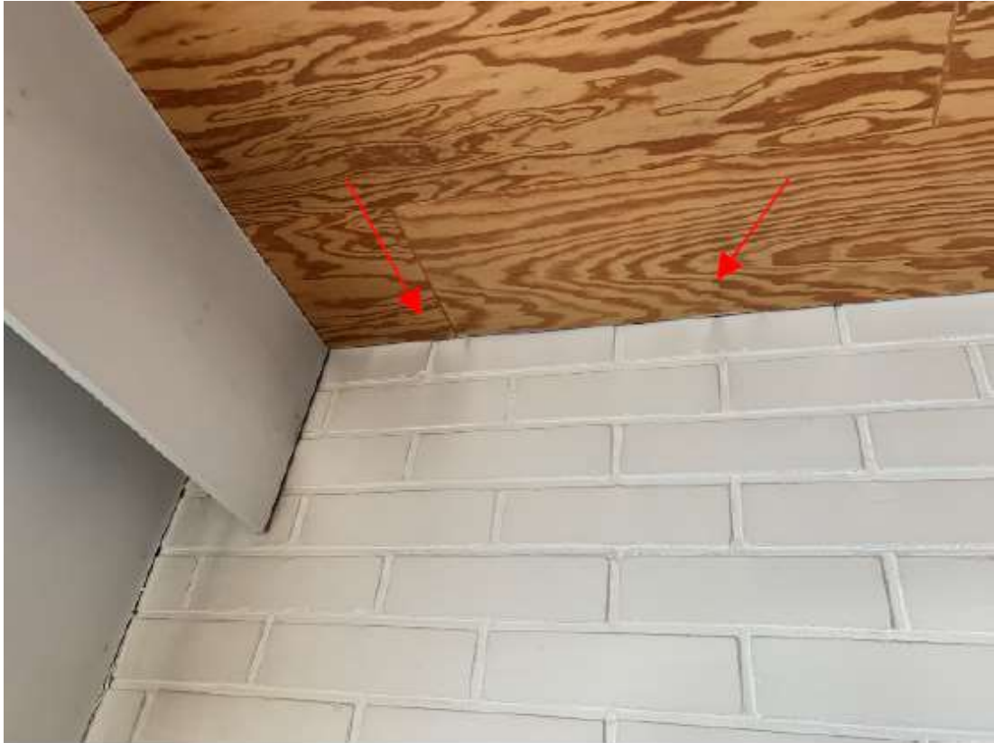
Kuva 23. Yläpohjan ja ulkoseinän liittymän ilmavuodoista viitteitä.
