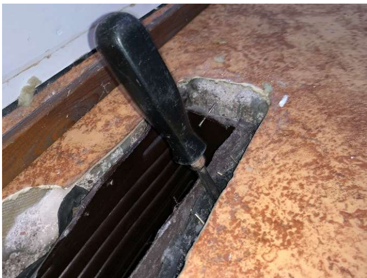
Kuva 27. Ilmanvaihdon päätelaitteen läpivienti epätiivis.
