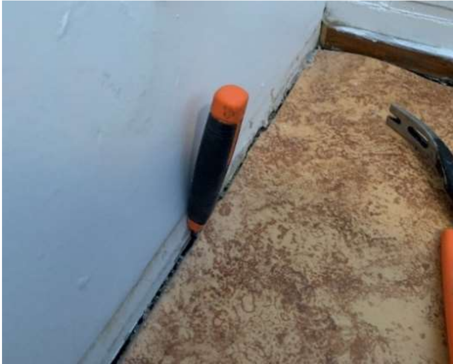
Kuva 14. Ilmavuotoreitti huoneistojen välisen seinän ja lattian liittymässä.
