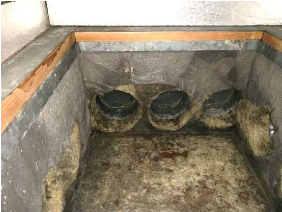
Kuva 25. Vanhan Valmet kotilämpölaitteiston jakolaatikossa havaittiin teollisten mineraalivillakuitujen lähde.
