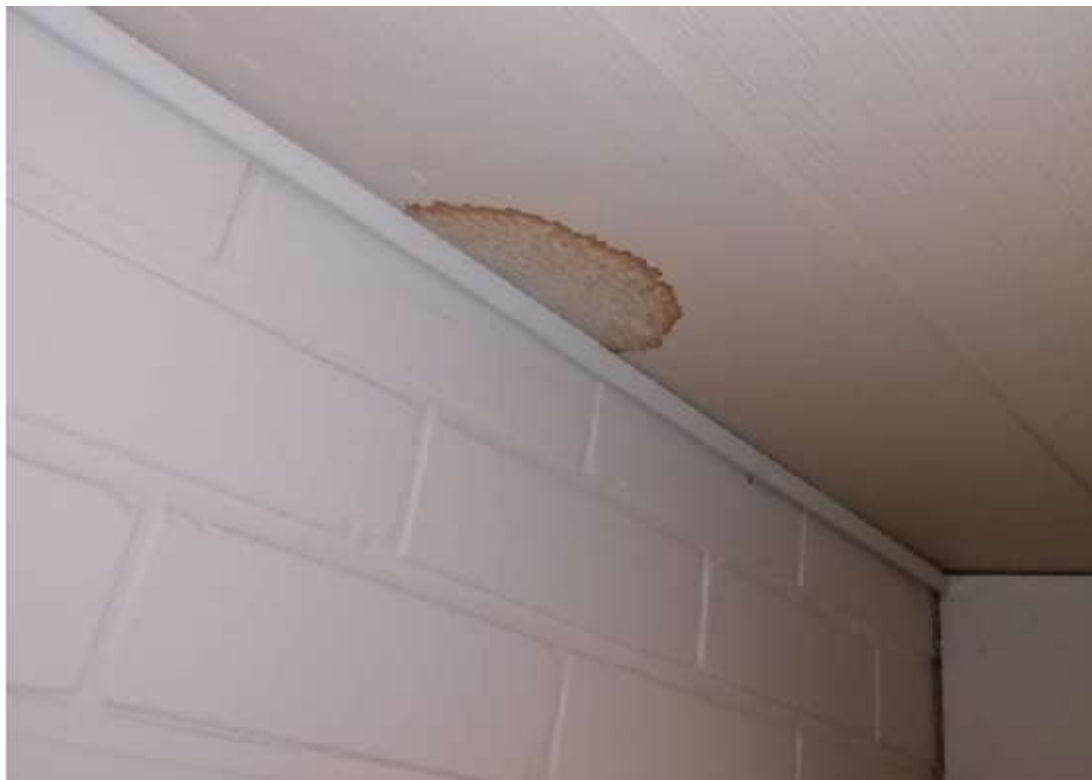
Kuva 24. Viitteitä vanhoista kattovuodoista sisäkatossa.
