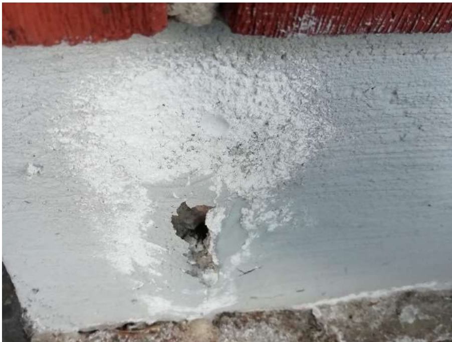
Kuva 11. Sokkeleissa havaittiin jälkiä kosteusrasituksesta.
