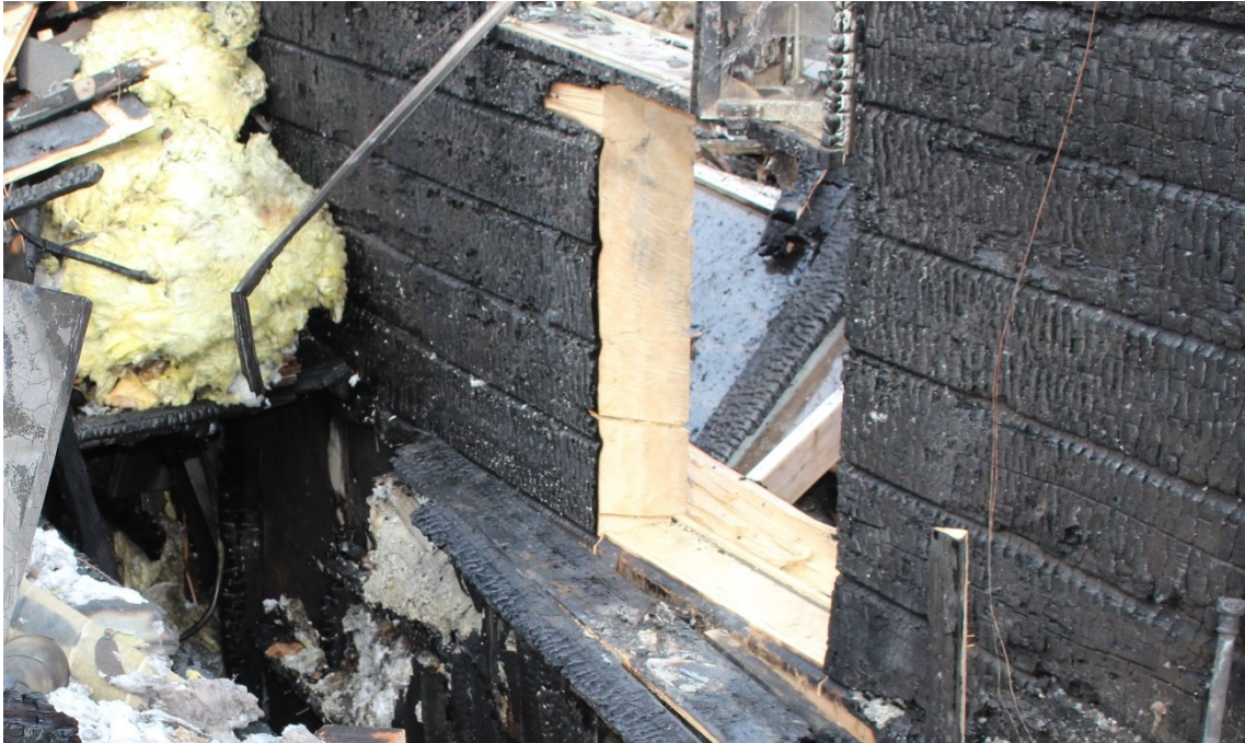
KUVA 7. Täyden palon vaiheessa olleen asuinrakennuksen hirsiseinää (34)
