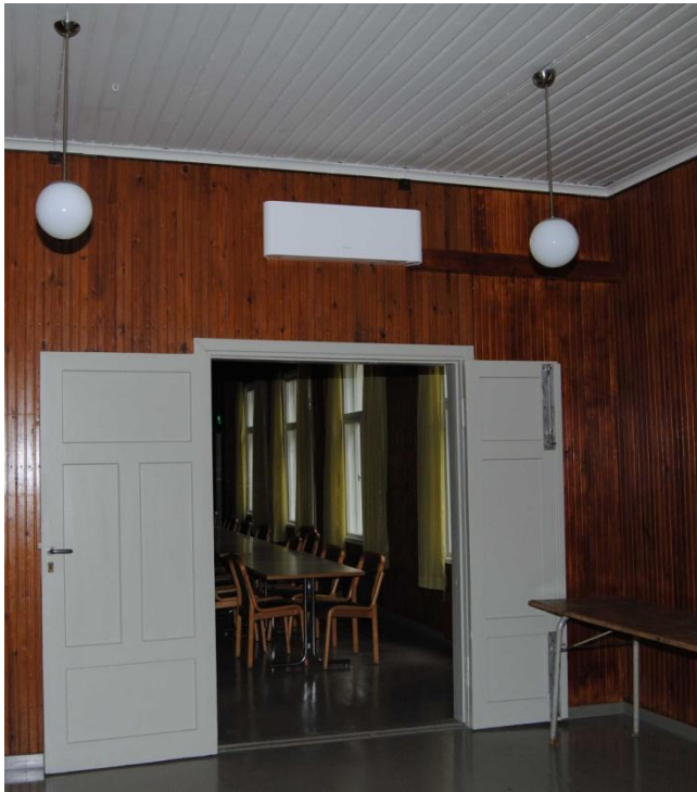
Kuva 2. Verlan seurantaloon toinen sisäyksikkö ja putkien kotelointi.
