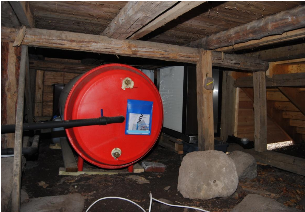
Kuva 4. Ulkoyksikkö ja lämminvesivaraaja kuistin alapuolella.
