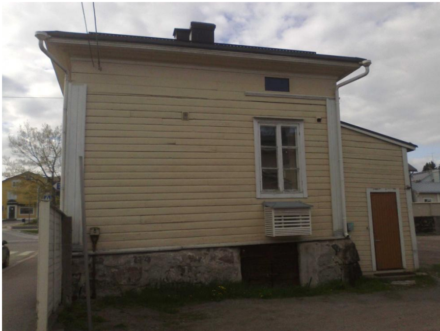
Kuva 6. Vanhassa Porvoossa olevan liikerakennuksen koteloitu ilmalämpöpumpun ulkoyksikkö.
