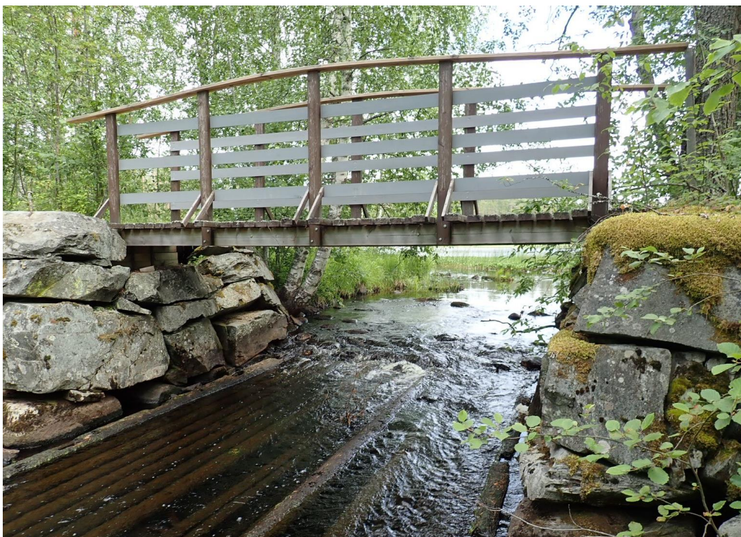
Kuva 33. Heinälammen vanha patopaikka voi muodostaa kiinteistön omistajan mukaan vaellusesteen kaloille vähän veden aikaan (Kuva: Jukka Oinonen).
