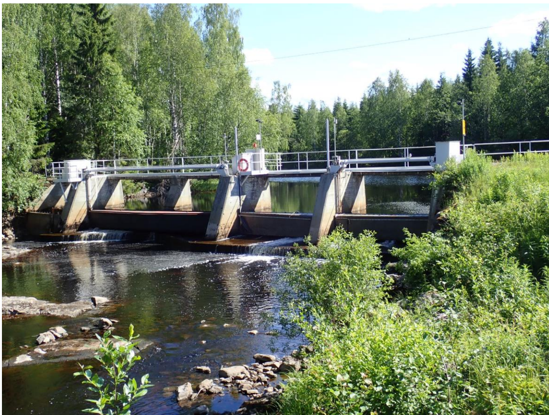
Kuva 16. Louhikosken voimalaitoksen säännöstelypato. Kalaporras on padon vasemmassa reunassa (Kuva: Jukka Oinonen).
