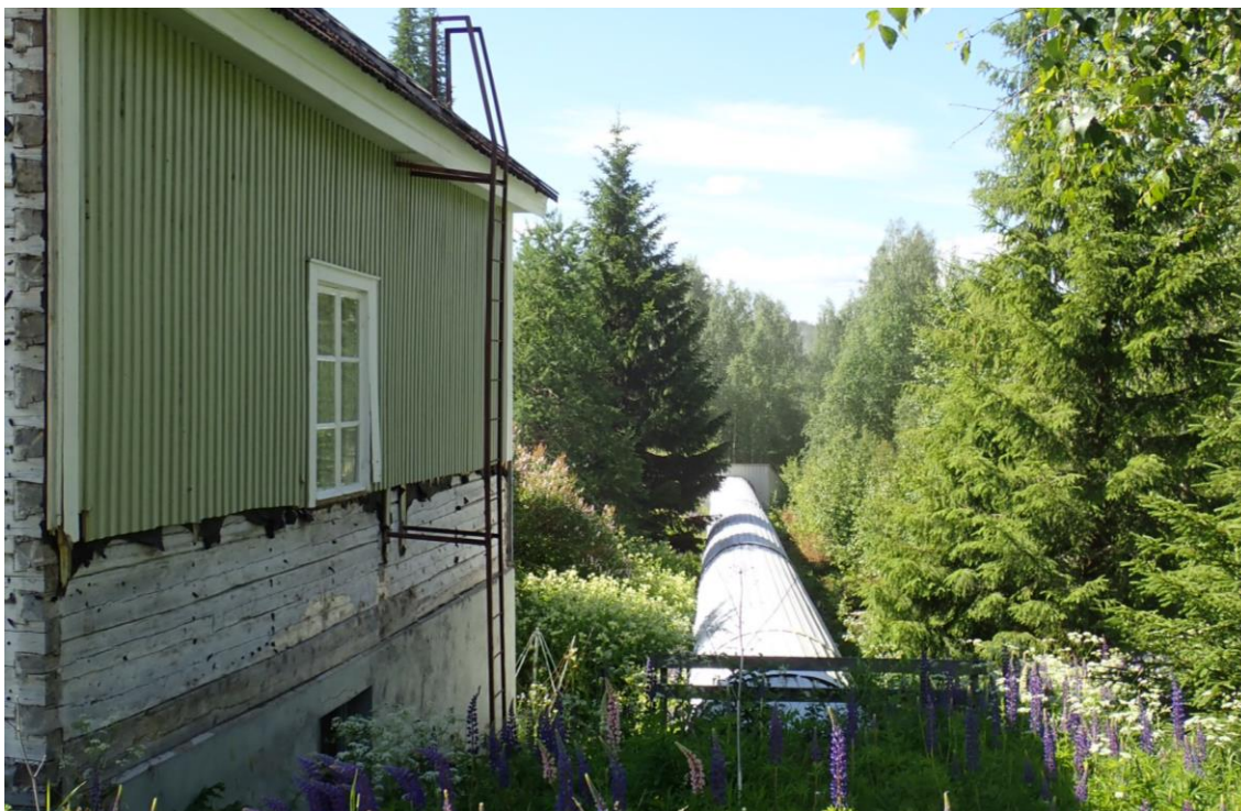
Kuva 19. Vesi ohjataan halkaisijaltaan 1,9 m olevaa tuloputkea pitkin voimalaitoksen turbiineille (Pohjois-Karjalan ympäristökeskus 2000, 4). Kuvassa vasemmalla on voimalaitosrakennus (Kuva: Jukka Oinonen).
