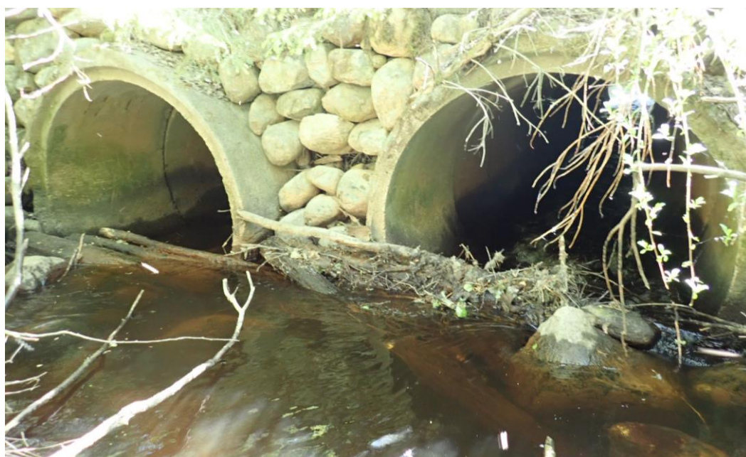
Kuva 22. Kohteella Siltapuro 4 virta oli kasannut puumateriaalia rumpujen yläpäähän, joka poistettiin maastokartoituksen yhteydessä (Kuva: Jukka Oinonen).
