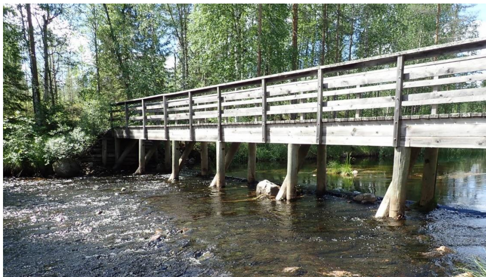
Kuva 23. Peurajoen välppäsillan tukipalkki voi muodostaa kulkua haittaavan esteen pienemmille kaloille vähän veden aikaan (Kuva: Jukka Oinonen).
