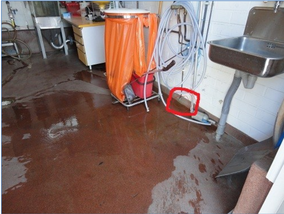
Kuva 9. Ylivuotoventtiilistä purkautuva neste tekee lattiat liukkaiksi
