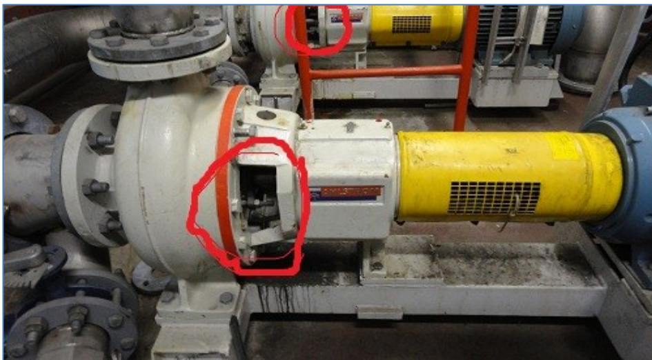
Kuva 8. Puutteellinen voimansiirron suojaus pumppu-moottori – yhdistelmässä
