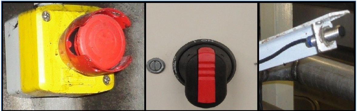
Kuva 60. Kuvassa vasemmalta: Hätäpysäytin, turvakytkin ja rajakytkin.
