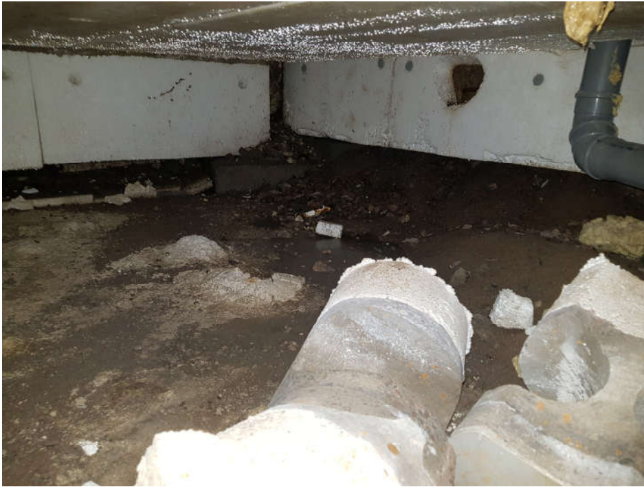
Kuva 16. Rakennusjätettä ryömintätilassa. Tiivistynyttä kosteutta ontelolaattojen alapinnassa.
