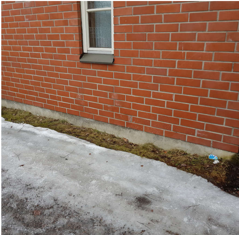
Kuva 14. Rakennuksia ympäröivä maan pinta on paikoin liian korkealla ja koostuu orgaanisesta maa-aineksesta.
