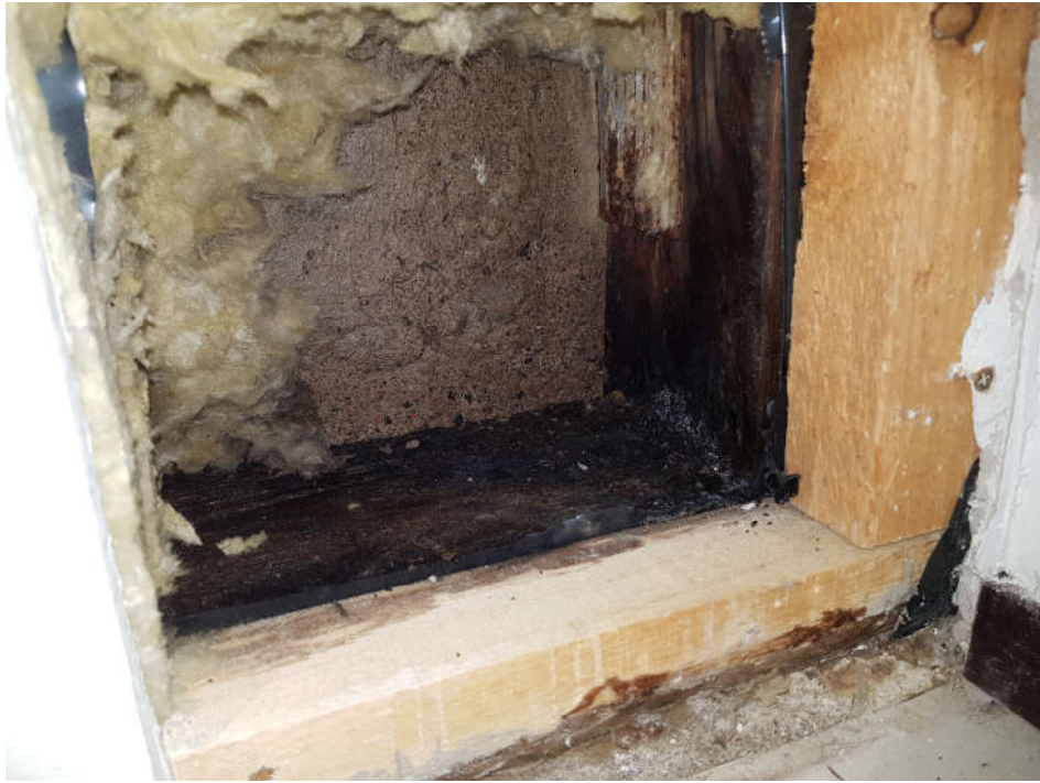
Kuva 19. Höyrynsulun ulkopuolisissa puu- ja lämmöneristerakenteissa havaittiin pitkälle edenneitä mikrobi- ja lahovaurioita.
