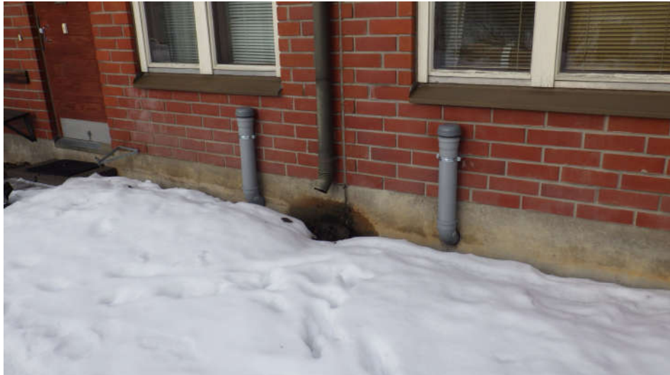
Kuva 15. Vesikaton puutteellinen sadevedenohjaus aiheuttaa maanvastaisiin rakenteisiin kosteusrasitusta.
