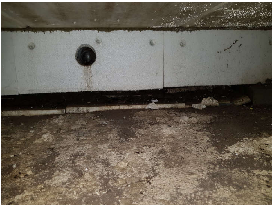
Kuva 17. Rakennuksen vierustalla kulkeva routaeriste on painunut.
