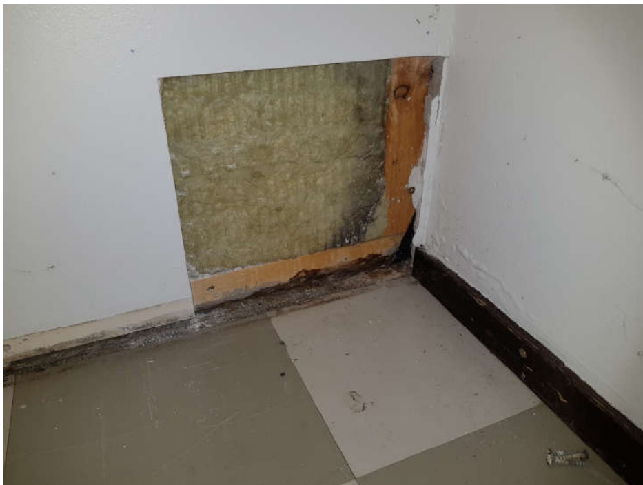
Kuva 18. Rakenteista otetuilla materiaalinäytteillä todettiin mikrobivaurio myös höyrynsulun sisäpuolella.
