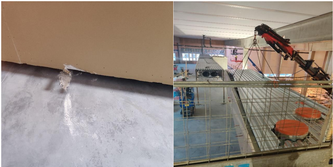
Kuva 17. Nostojen aikana vahingoittunut kipsilevy vasemmalla ja oikealla vääntynyt kattoprofiili
