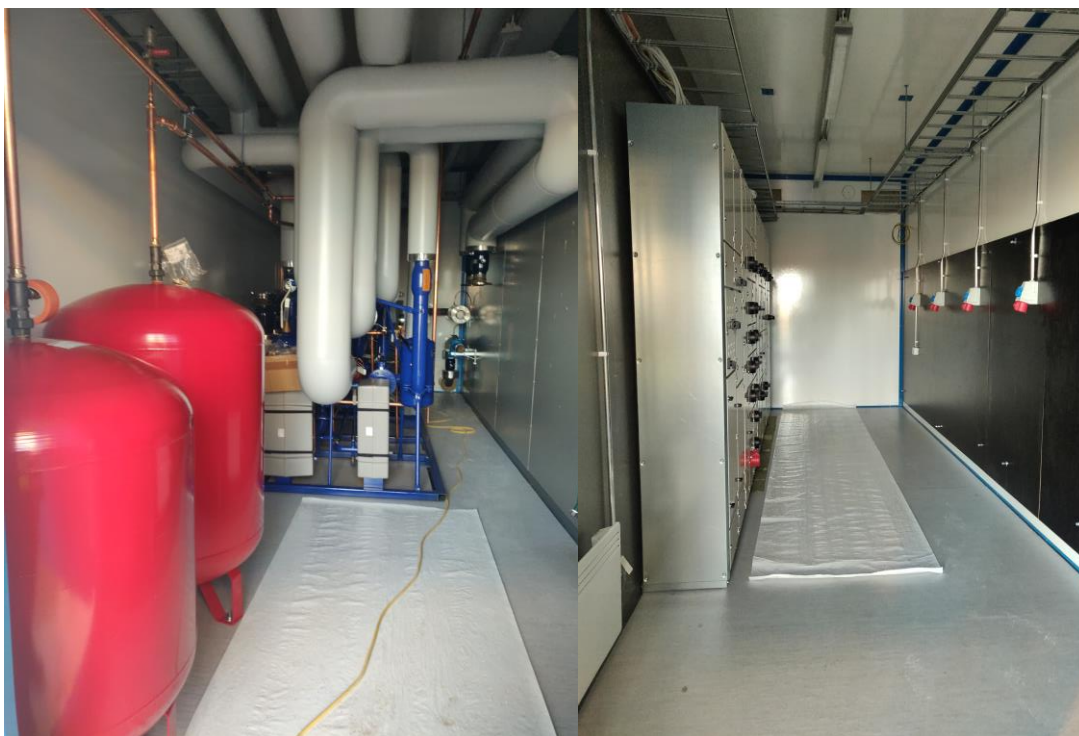
Kuva 19. Energiamoduulit sisältä kuvattuna. Vasemmalla lämmönjakokeskus ja oikealla sähkönousukeskus
