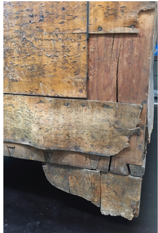
Kuva 16. Oikean sivun viiluvaurioita.
