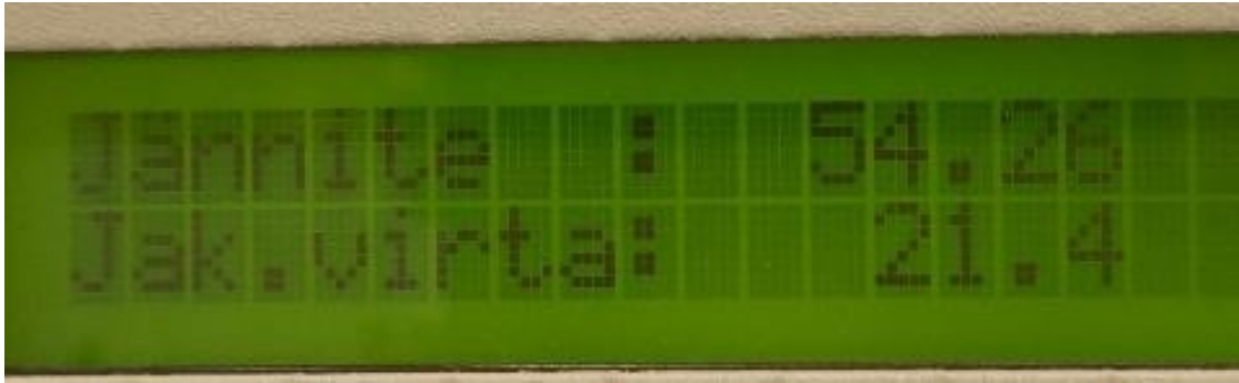
KUVA 8. Laitetilan kellarikerroksen puhelinvaihtehuoneen tehonkulutuslukema ennen 5G-asennusta (Telia, kuvia 5G-asennuksesta 2019)
