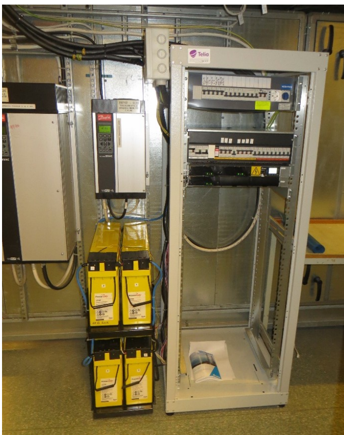
KUVA 15. Laitetilan yläkerran IV-huone 5G-asennuksen jälkeen (Telia, kuvia 5G-asennuksesta 2019)
