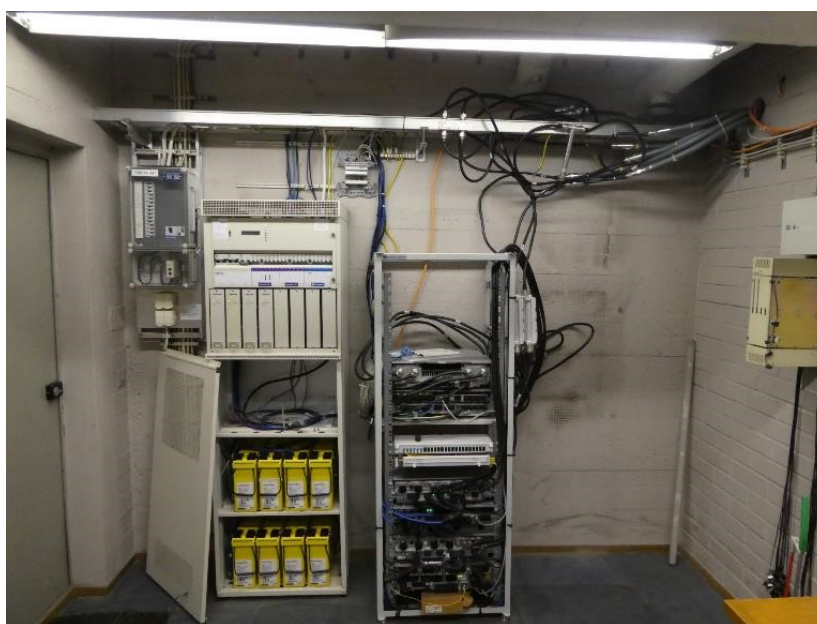
KUVA 7. Laitetilan kellarikerroksen puhelinvaihdetuone ennen 5G-asennusta (Telia, kuvia 5G-asennuksesta 2019)
