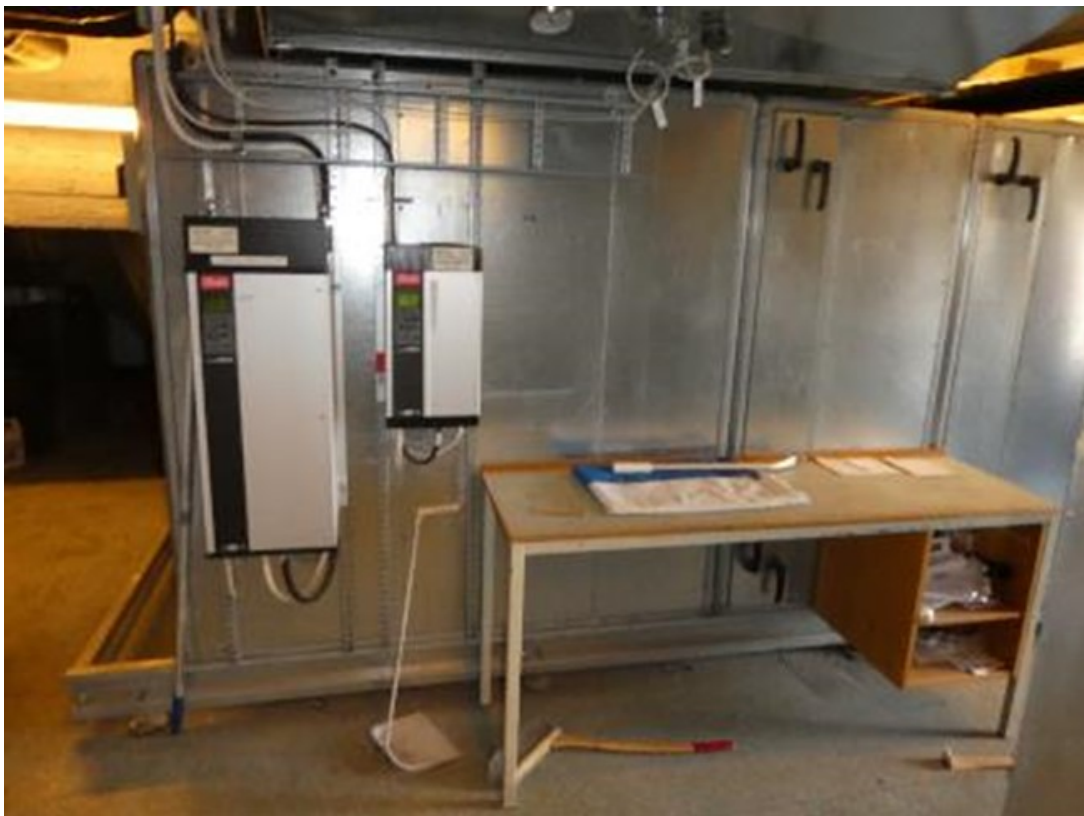
KUVA 14. Laitetilan yläkerran IV-huone ennen 5G-asennusta (Telia, kuvia 5G-asennuksesta 2019)
