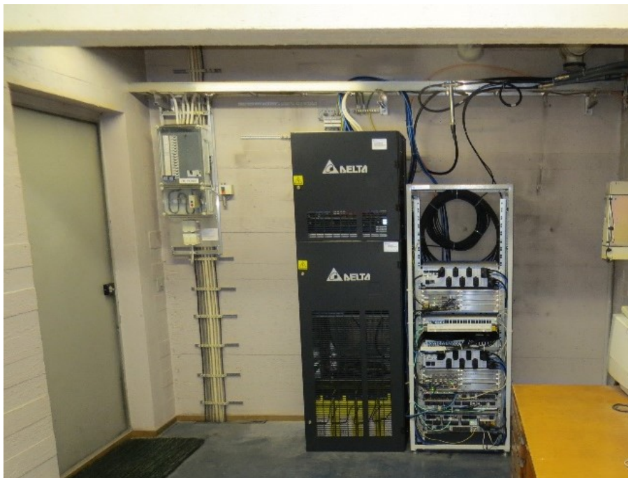
KUVA 11. Laitetilan kellarikerroksen puhelinvaihtuhuone 5G-asennuksen jälkeen (Telia, kuvia 5G-asennuksesta 2019)
