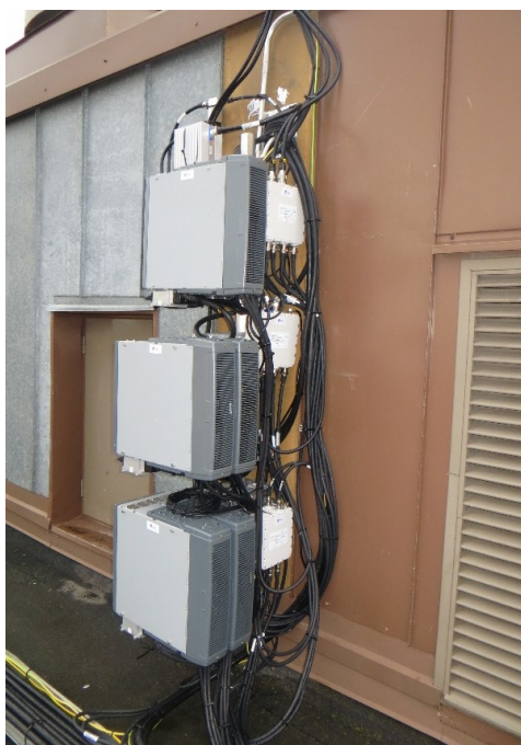
KUVA 13. Radioyksiköt laitetilan katolla 5G-asennuksen jälkeen (Telia, kuvia 5G-asennuksesta 2019)
