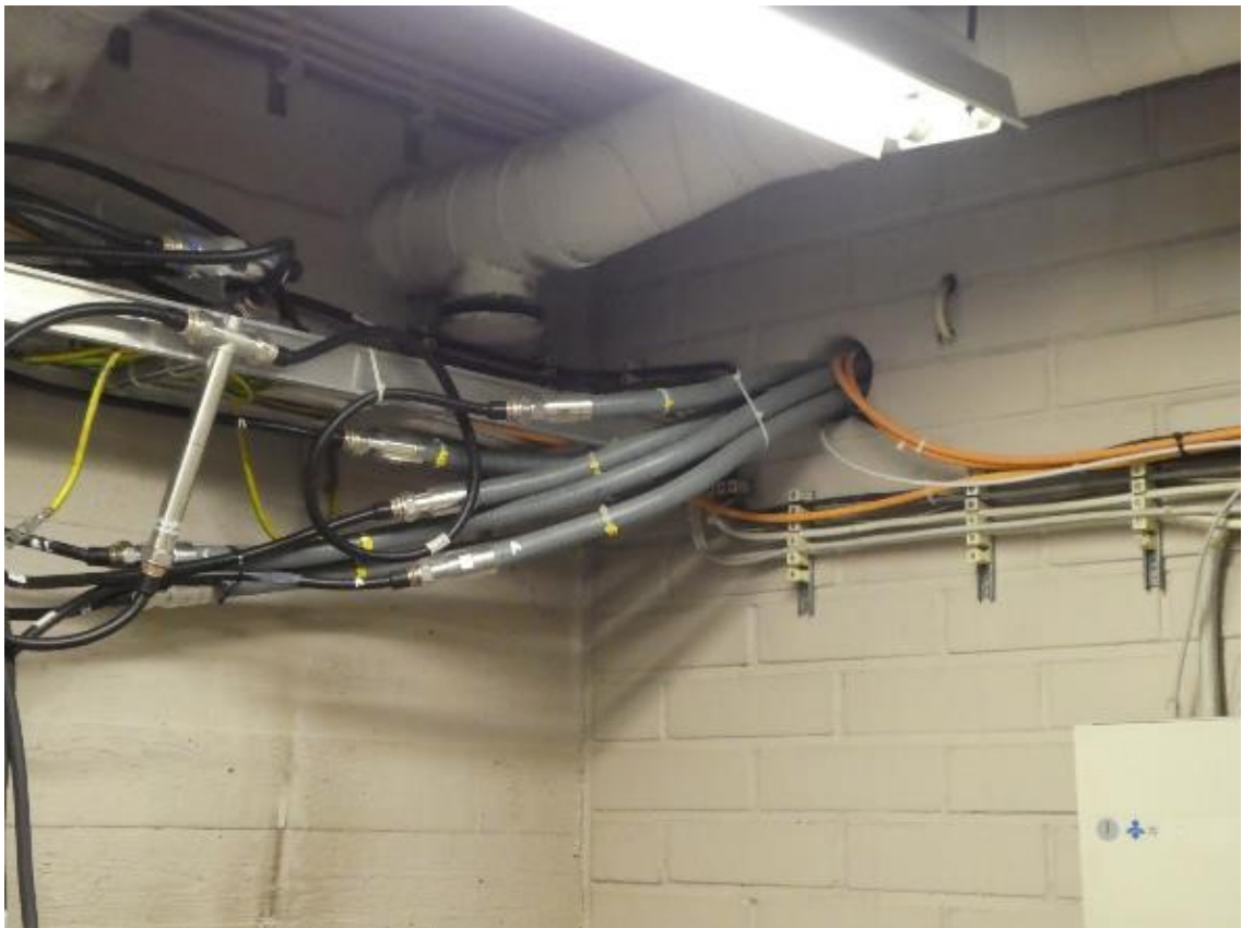
KUVA 9. Laitetilan kellarikerroksen puhelinvaihtehuoneen ilmanvaihto laitetilassa (Telia, kuvia 5G-asennuksesta 2019)
