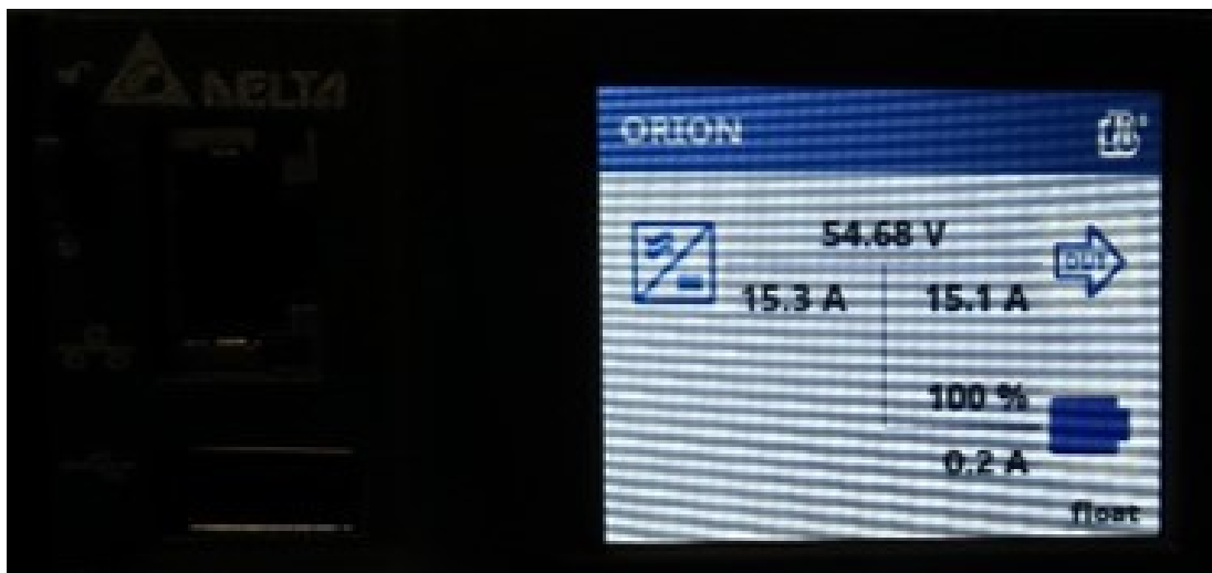
KUVA 12. Laitetilan kellarikerroksen puhelinvaihtehuoneen tehonkulutuslukema 5G-asennuksen jälkeen (Telia, kuvia 5G-asennuksesta 2019)
