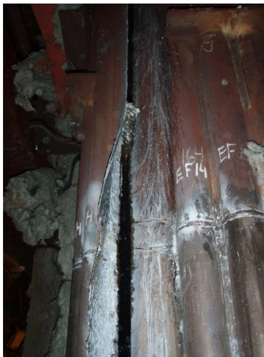
Kuva 9. Soodakattila SK1:n tulistajien syöttöveden putkivaurio, joka mahdollisti veden pääsyn tulipesään (kuva J. Mäkelä).
