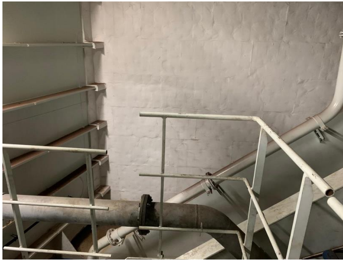
Kuva 26. Ilmastointikompressorihuoneen paapuurin sijoituspaikka (Nikula 2020)
