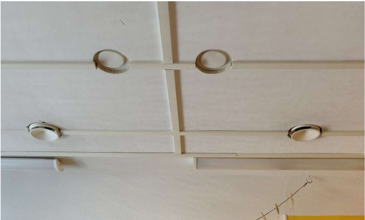
KUVA 16 Yläkerran aulan tuloilmaventtiilit
