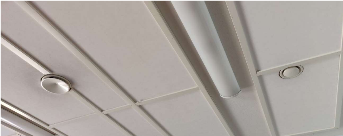
KUVA 15 Alakerran ruokailutilan tulo- ja poistoilmaventtiili
