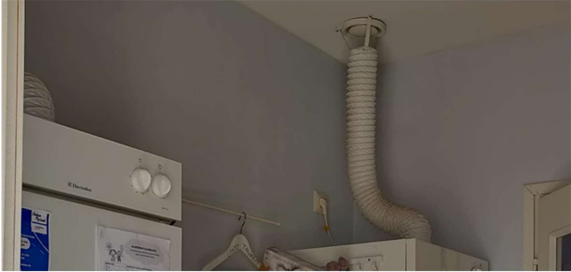
KUVA 27 Tuulikaapin kytkentä poistoelimeen
