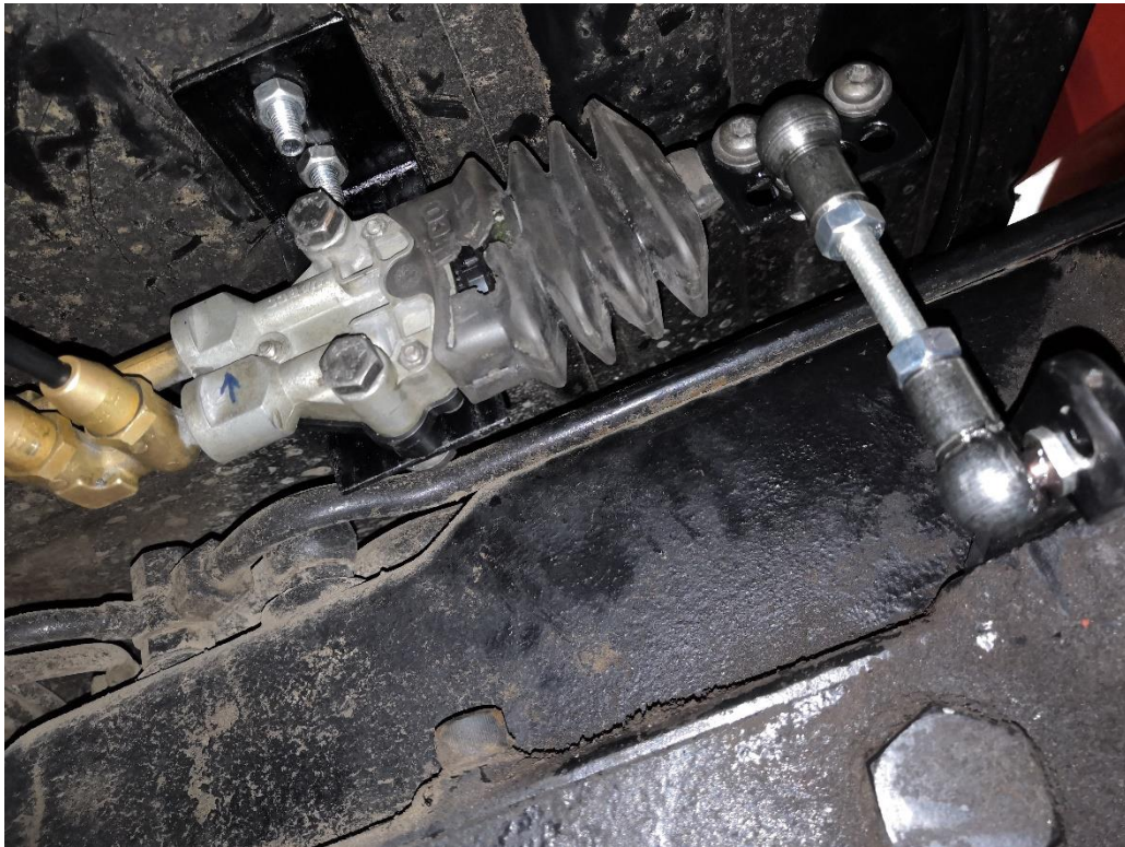
Kuva 8. Tasonsäätöventtiili ohjaamon lattian alla.
