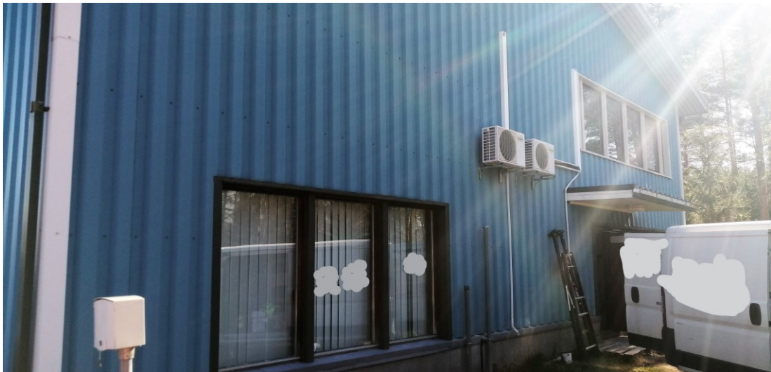
Kuva 10. Toimiston pääty ja ilmalämpöpumppujen ulkoyksiköt
