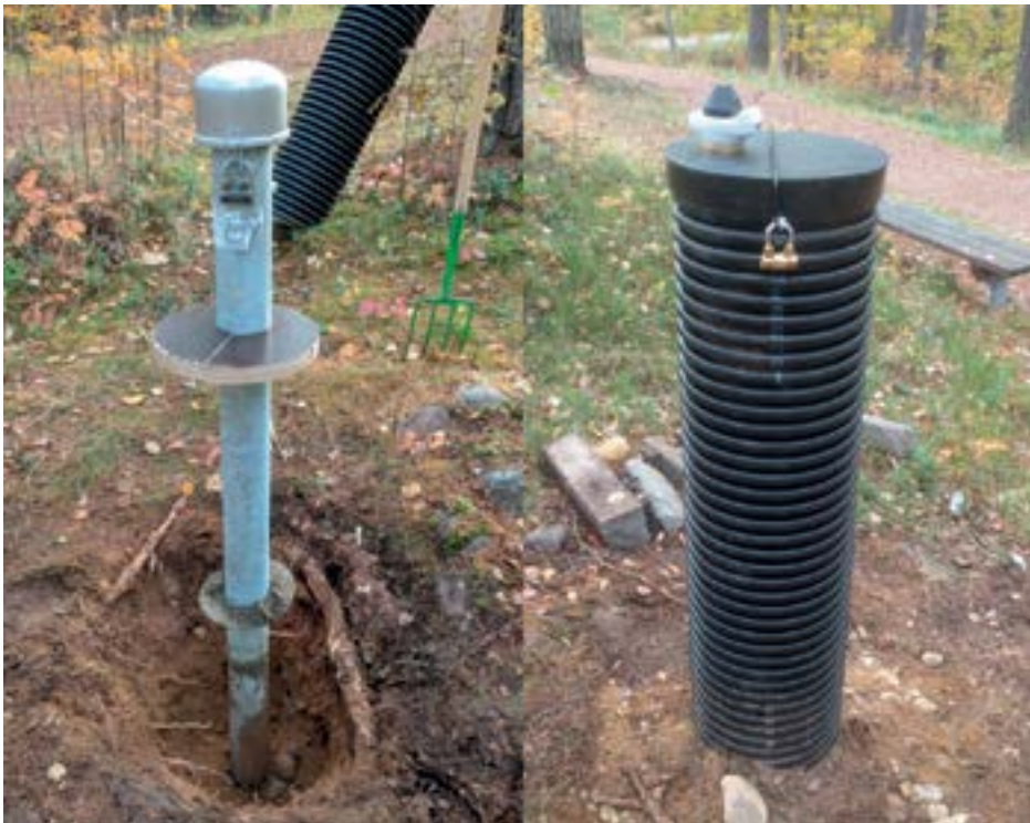
Kuva 3. Monitorointiasemien suojakotelo asennustilanteessa ja valmiina. Vasemmalla näkyvässä putkeen tehty välitasanne, joka estää tarvikkeiden tippumisen syvemmälle koteloon. (Kuva Aki Mykkänen)
