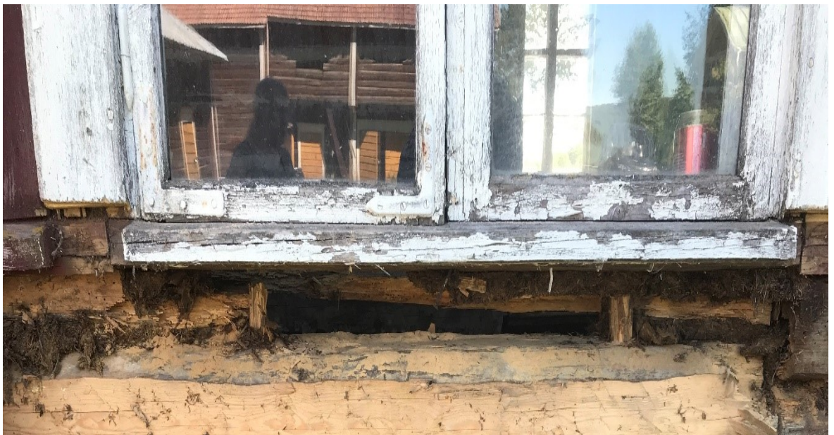
Kuva 29. Hirsirunkoon syntyneitä vaurioita ikkunan alla.
