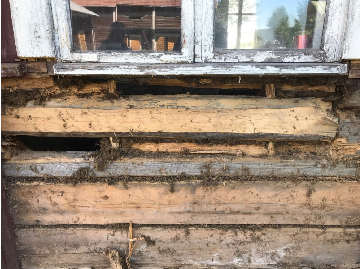
Kuva 53. Ikkunan alusvauriossa ja aikaisemmin tehdyissä hirsikorjauksissa havaitaan eri aikakausien hirsyä.
