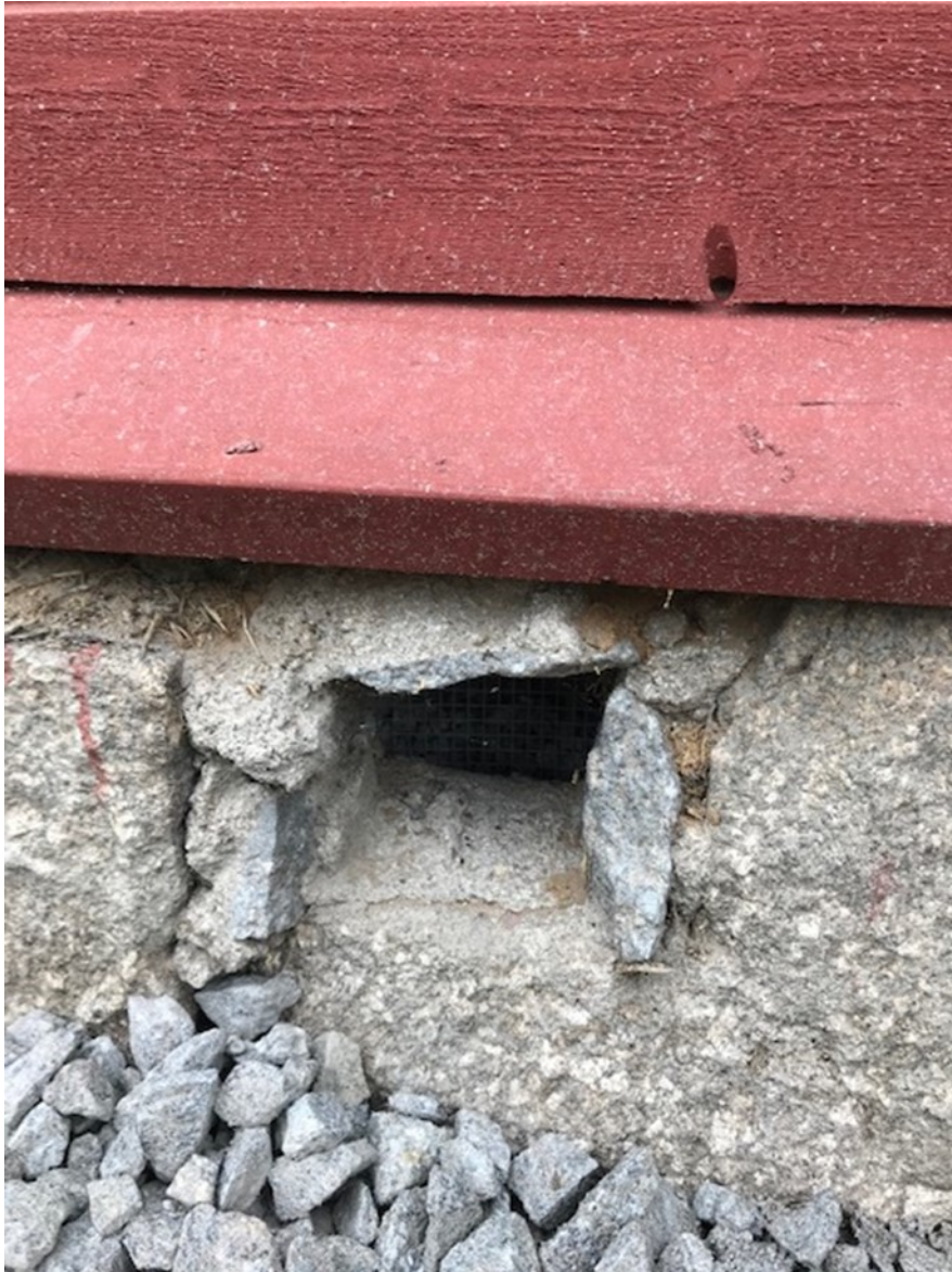
Kuva 52. Tuuletusputken pää asettuu oikeaoppisesti vesilistaa sisemmäksi, kuten koko kivijalkakin.
