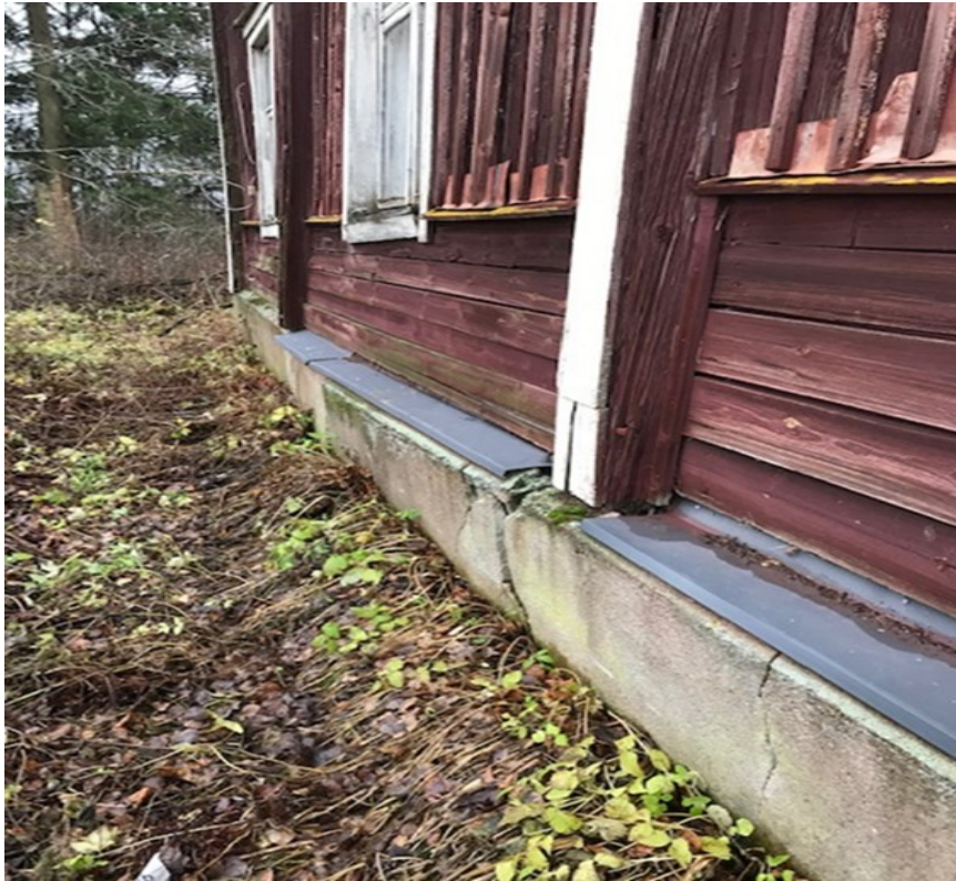
Kuva 18. Luonnonkiviperustuksen betonikuori sekä maatunutta kasvustoa.
