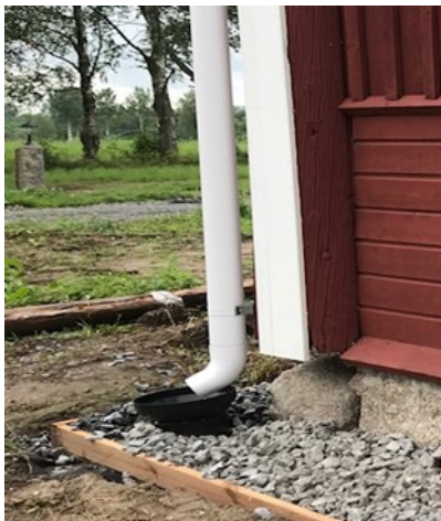
Kuva 47. Hulevedet johdetaan pois rakennuksesta umpiputkilla sadevesikaivojen kautta.
