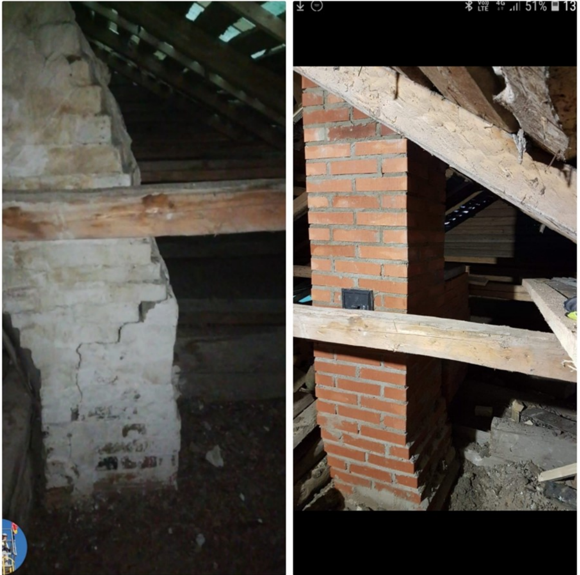
Kuva 38. Vaurioitunut hormi ja vieressä uudesti muurattu piipun yläosa välipohjaan asti.
