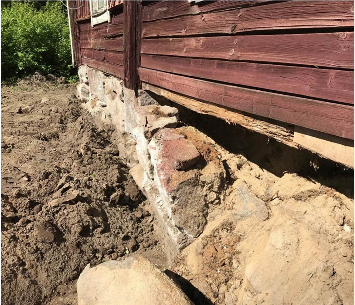
Kuva 50. Eteläpäädyn multapenkin reunakivet sortuivat betonimanttelin purkamisen yhteydessä.
